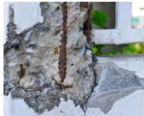
Figure 159 : Béton abîmé par des sulfates
