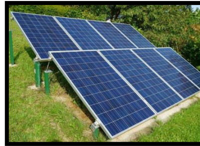
● Panneaux solaire ● Les éoliennes
