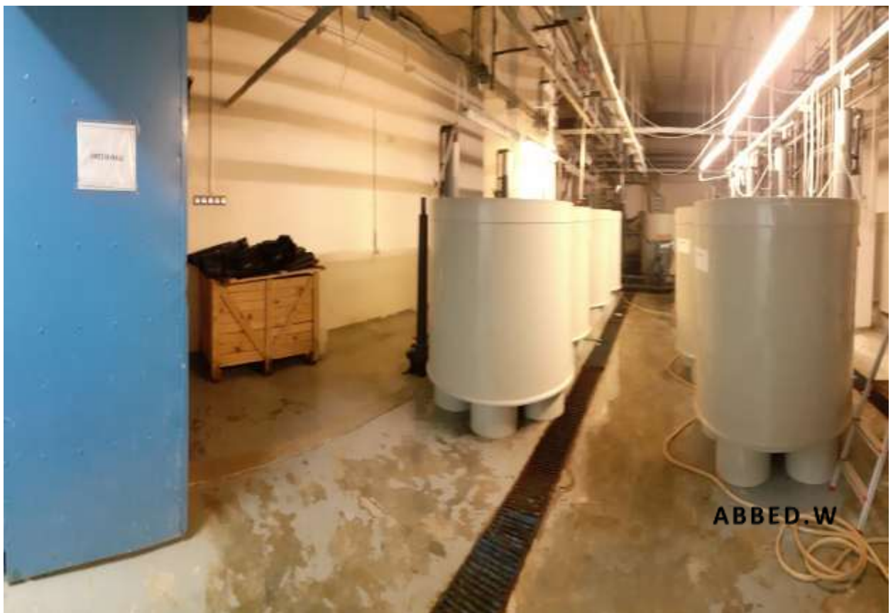
Figure.26 : Bloc de sevrage de poissons.
