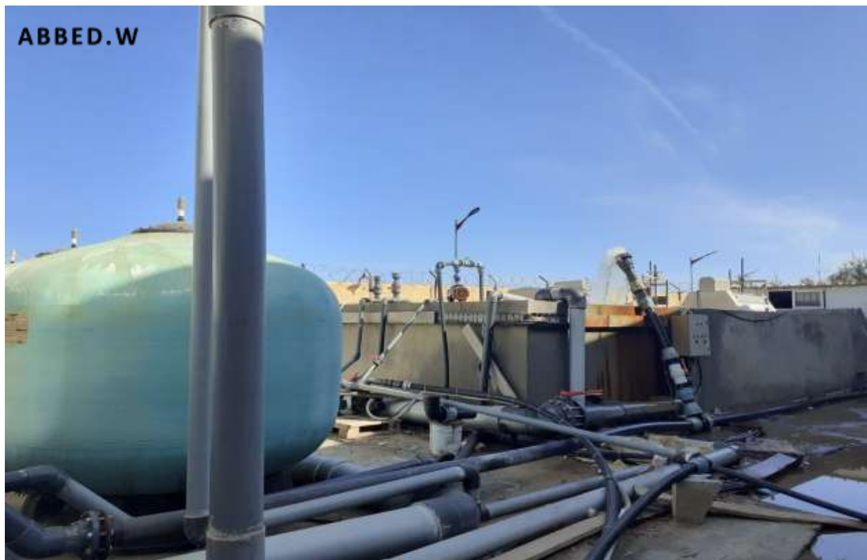
Figure 33: Le réservoir général de l'eau de mer.
