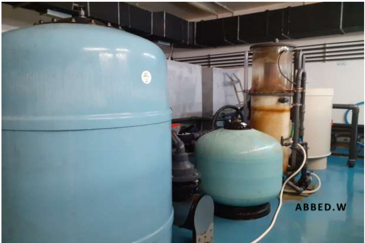
Figure.29 : Unité de filtration de l'eau du système de circuit fermé de la salle de prégrossissement.
