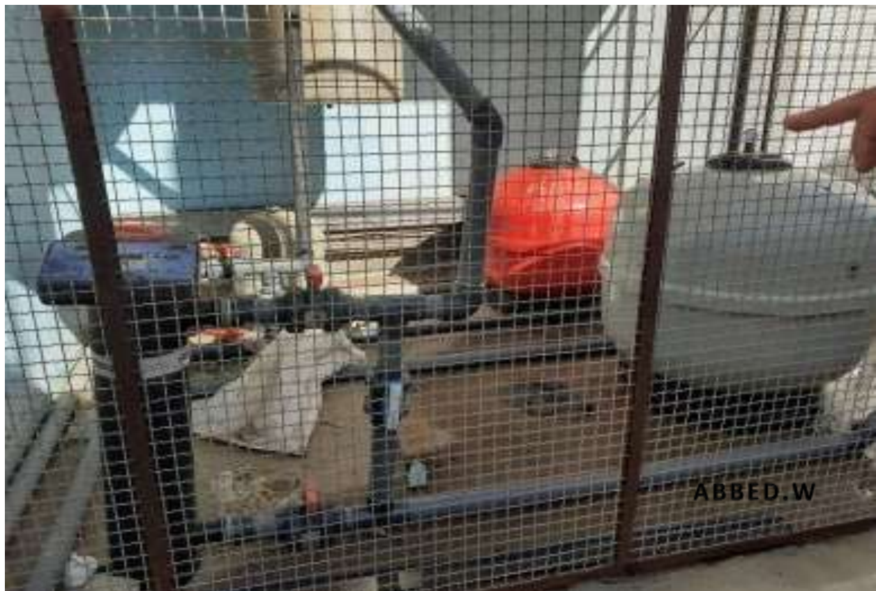
Figure.34 : Le filtre à sable et le filtre biologique du réservoir général de l'eau de mer.
