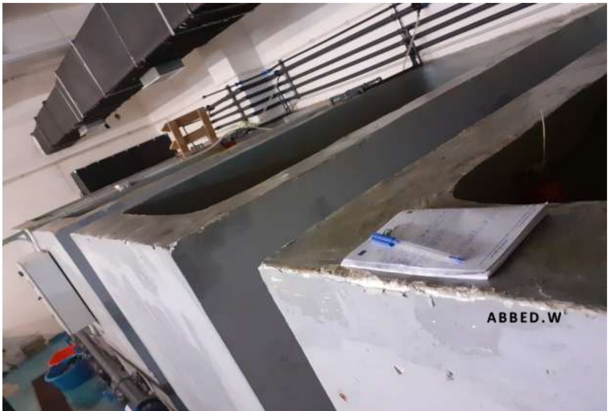
Figure.27 : Salle de bassins réservoirs d'eau pour maintenir le système de circuit fermé.
