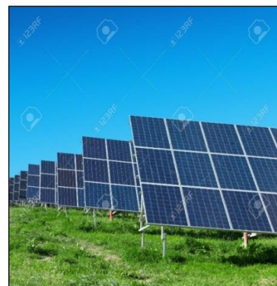
Figure 3.32 : panneaux solaire photovoltaïque
