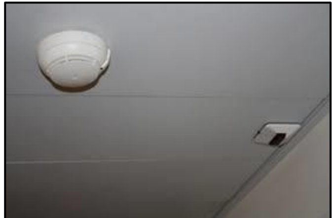
Figure 4.13 : Détecteurs automatiques incendie
