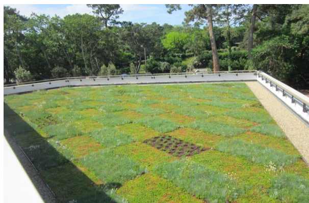
Figure 12 : un toit vert
