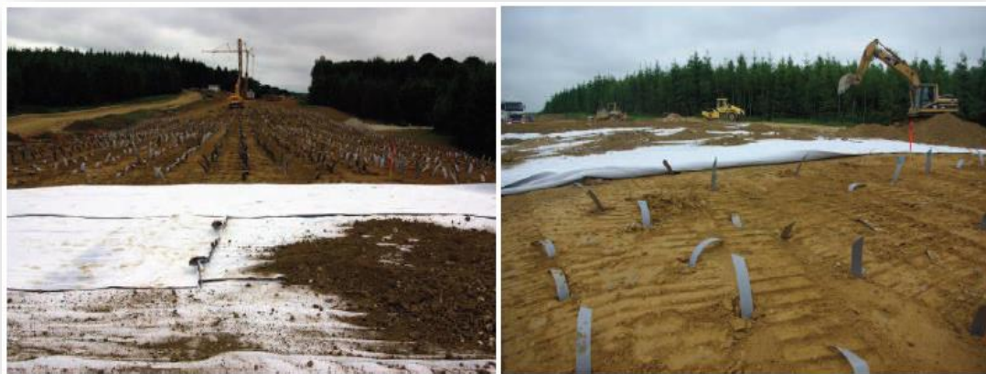
Figure I.63 : mise en œuvre du géocomposite de drainage horizontal et connexion avec les drains verticaux.
