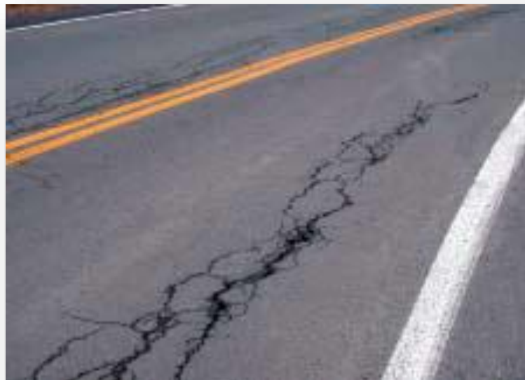
Figure I.16 : fissures de fatigue ou retrait.
