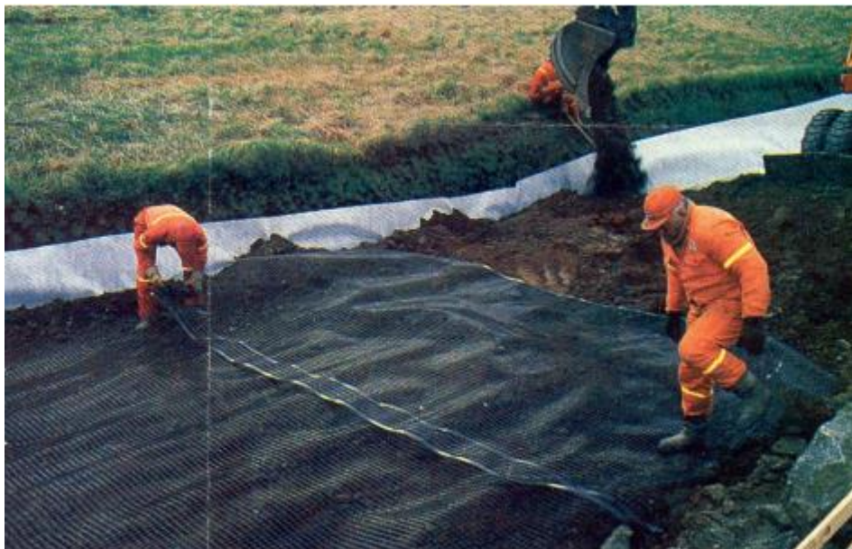
Figure II.8 : installation de la géogrille de renforcement lors de la réhabilitation d'une route à Vesterålen, Norvège (Myhre, 1985).
