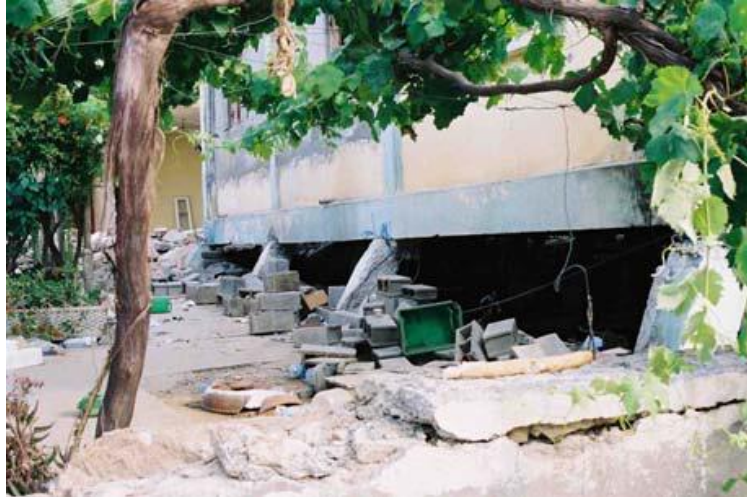
Figure 7.11 : Cisaillement des poteaux court du vide sanitaire.
