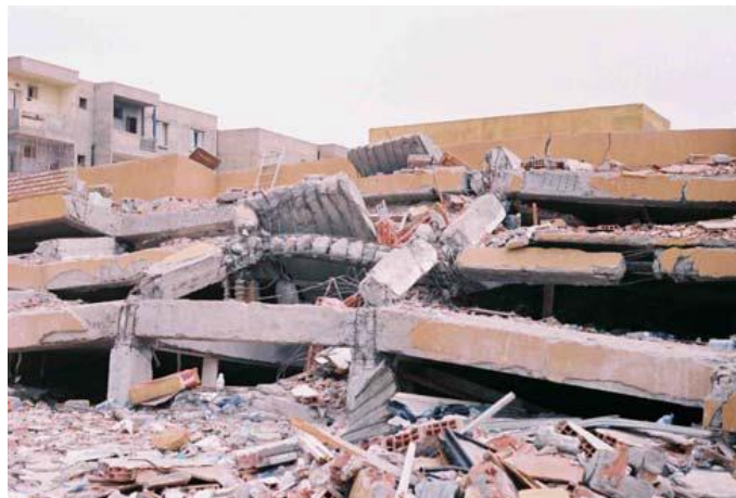
Figure 7.6 Effondrement des bâtiments en mille-feuilles.
