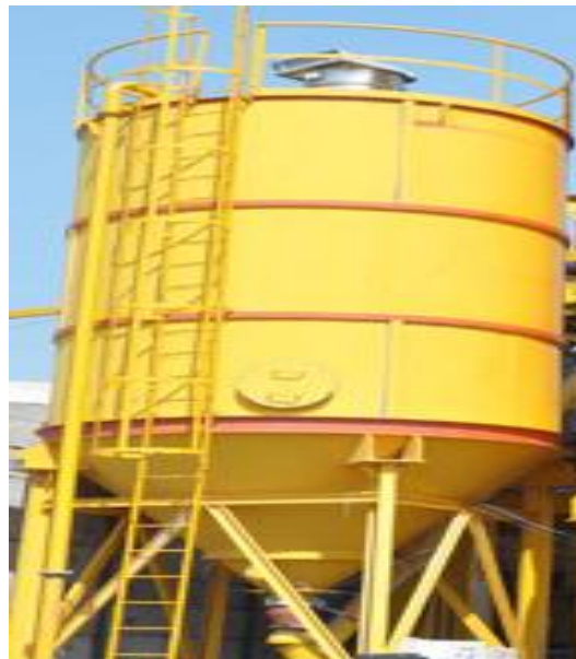
Figure II-11 : silo de stockage sable
