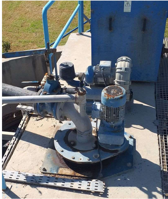
Figure II.3 : Moteur de dégrilleur de la station
