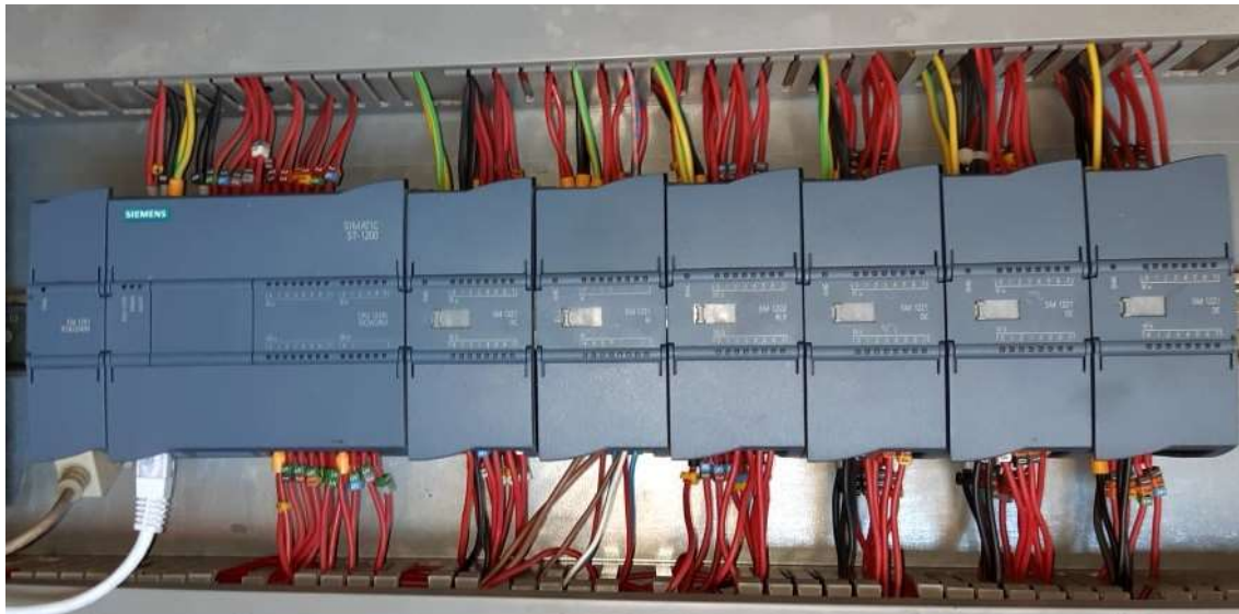
Figure III.3 :L'Automate S7-1200 dans notre Armoire
