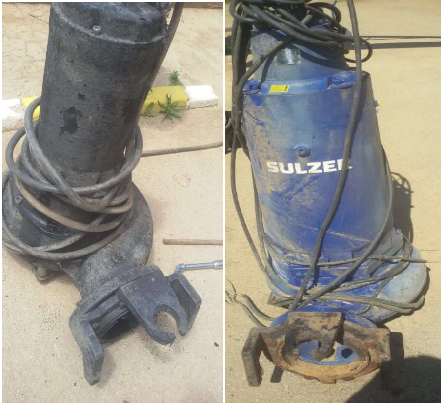
Figure II.2 : Les pompes de relevage de la station
