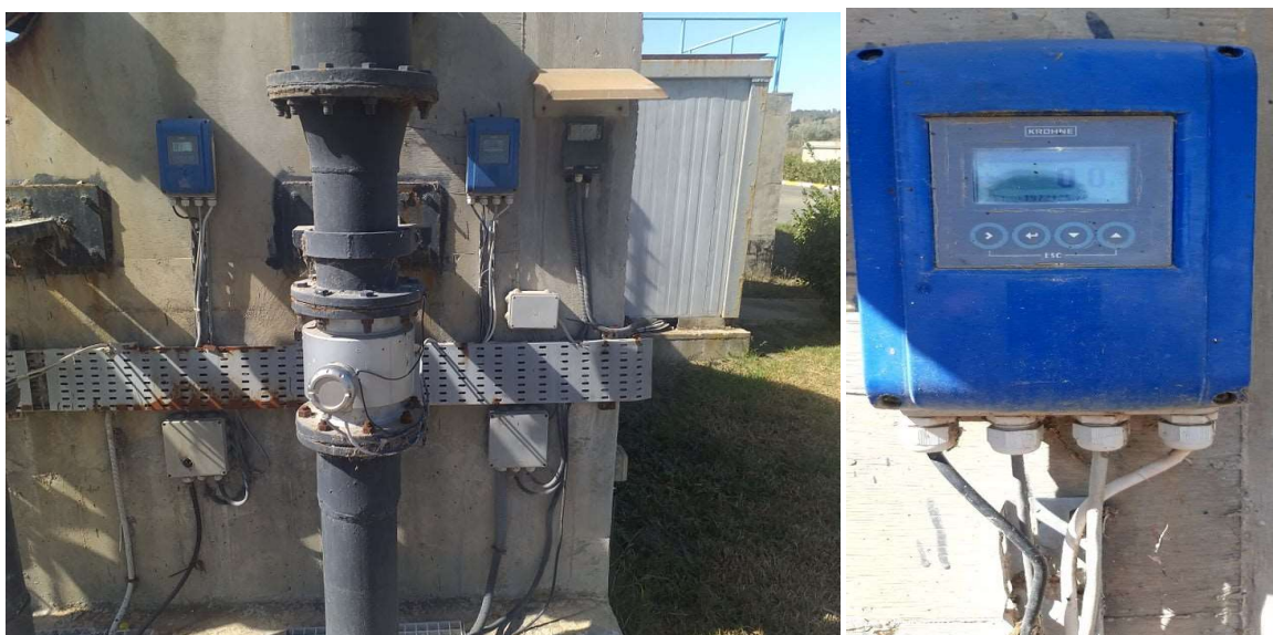
Figure II.7 Le débitmètre électromagnétique de la station
