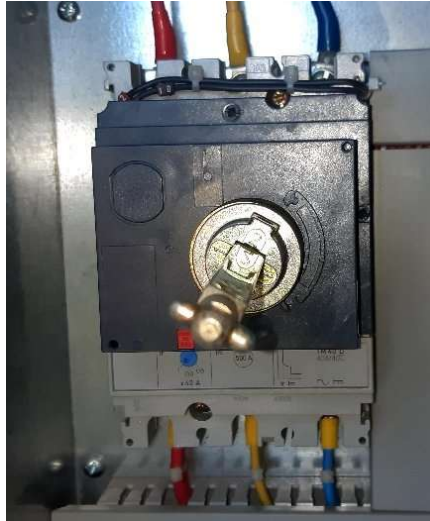
Figure II.10 : Le disjoncteur principal de l'armoire
