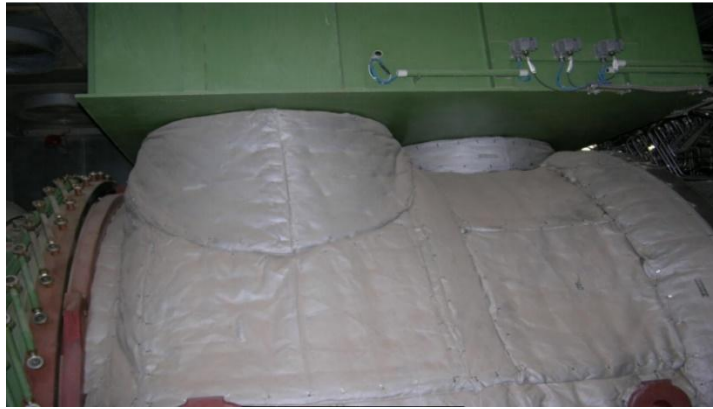
Figure I-18 : Le compresseur (vue d'extérieur) avec la vanne anti-pompage au-dessus (en vert)
