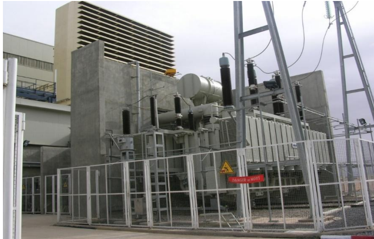
Figure I-24 : Transformateur principal TP
