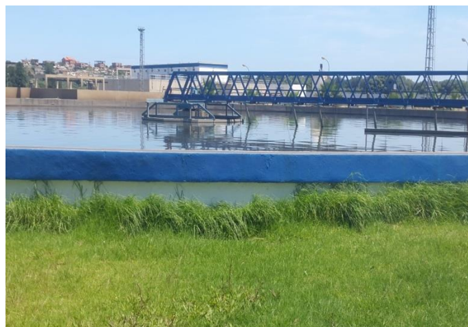
Décanteur primaire de la STEP Réghaia ( photo originale )
