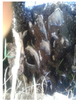
Conduite abandonné (G6)
