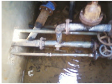
Chambre des vannes(G04)
