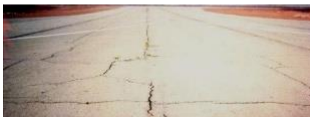
Figure 5.1: Fissures transversales au niveau de la chaussée
