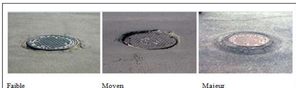
Figure 2.19: Dénivellation des regards et des puisards.
