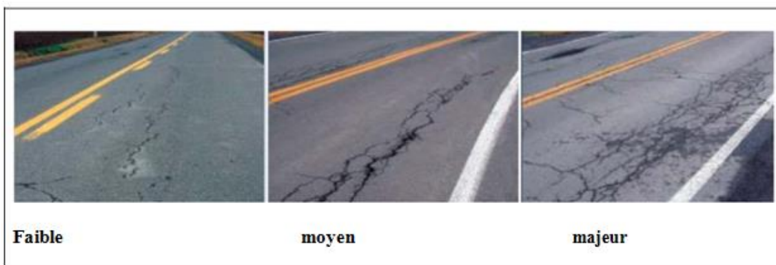
Figure 2.7: Fissures en piste de roues.
