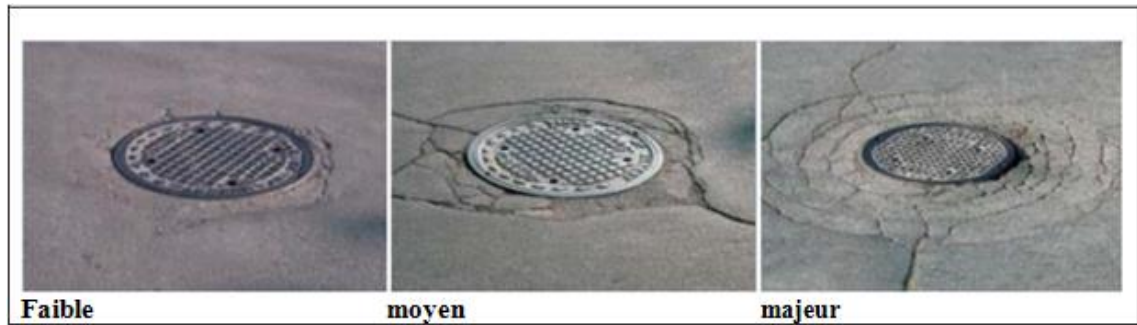
Figure 2.17: Fissuration autour des regards et des puisards.
