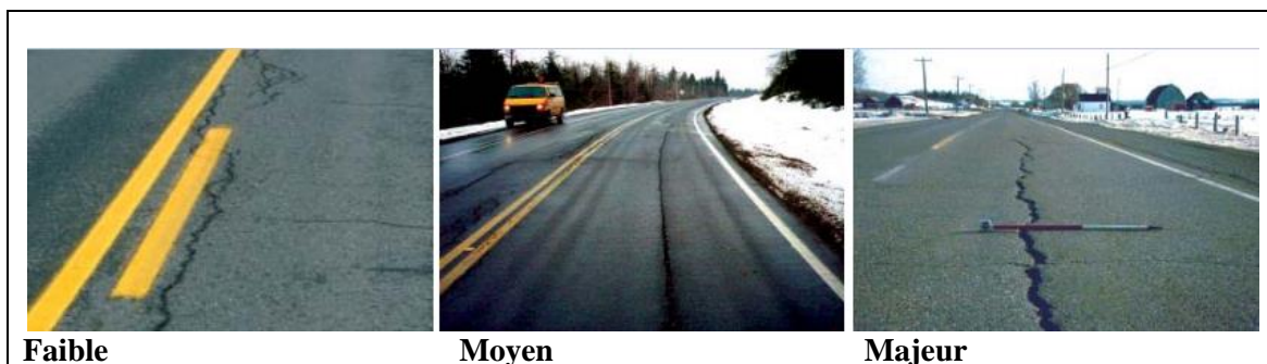
Figure 2.8 Fissures longitudinales hors piste de roues.
