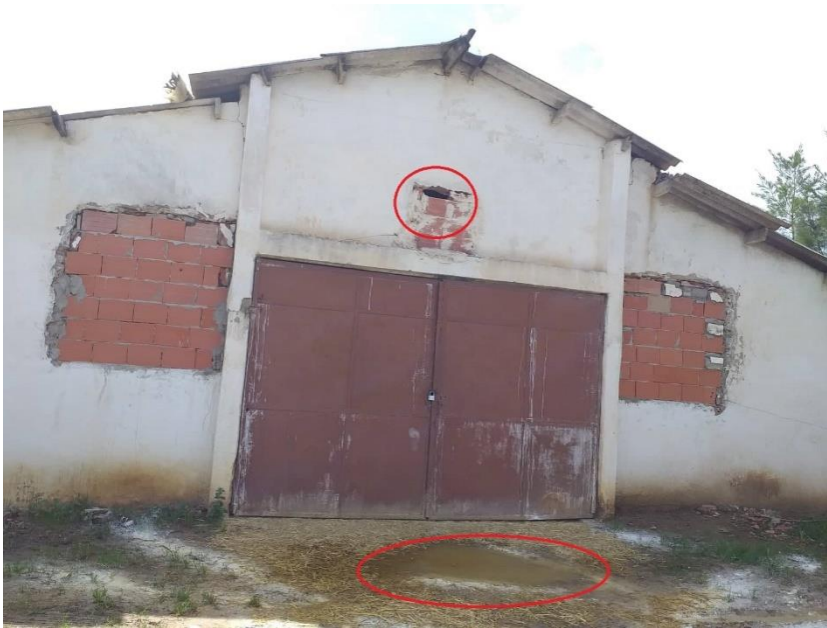
Trou non fermé risque d'accès des oiseaux étrangers.
