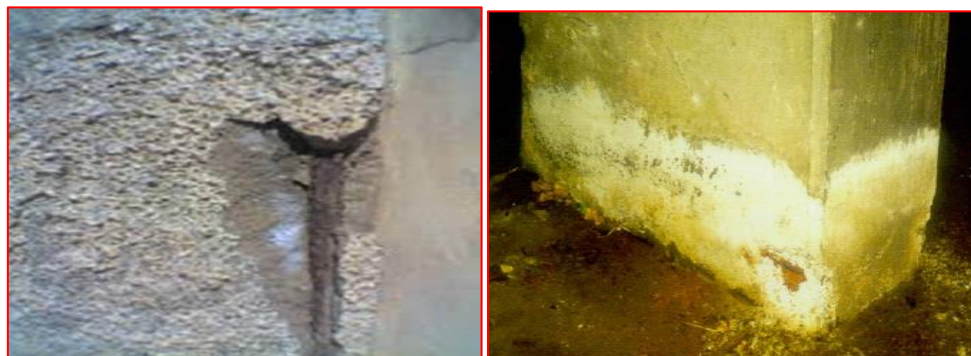
Figure I.4 : Attaques de sulfates sur le béton
