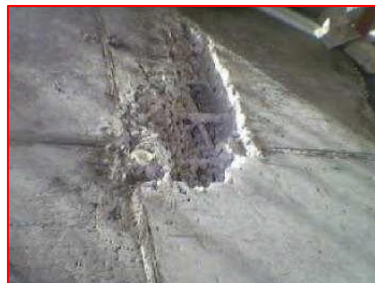
Figure I.14 : dommages sur le béton engendrés par la ségrégation
