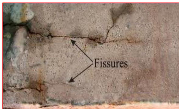
Figure I.12 : représentation de fissures visibles sur la surface d'un béton
