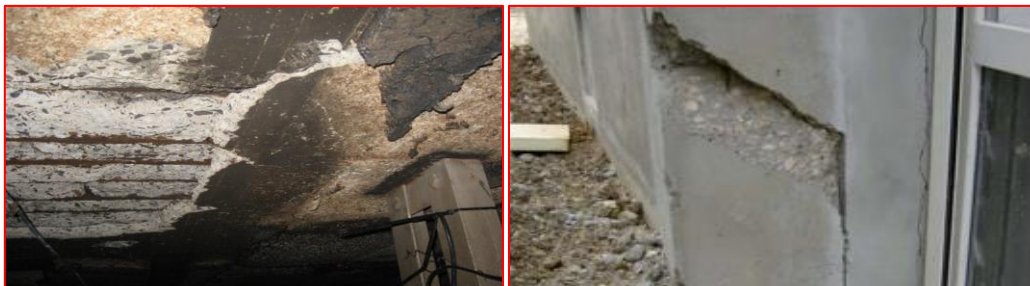
Figure I.16 : Eclatement de l'enrobage du a un incendie et au choc
