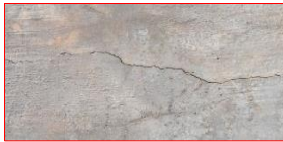
Figure I.15 : Effet du Ressuage sur le béton
