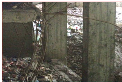
Figure IV.12 : Déformation et corrosion des armatures
