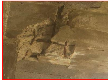
Figure IV.7 : Fissuration et mauvaise mise en œuvre due à un défaut d'exécution
