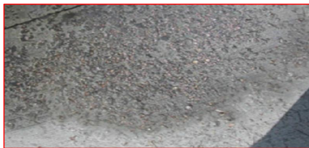
Figure I.7: dégradation due aux sels de déverglage
