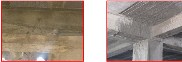
Figure IV.6 : Différentes colorations du béton mis en place
