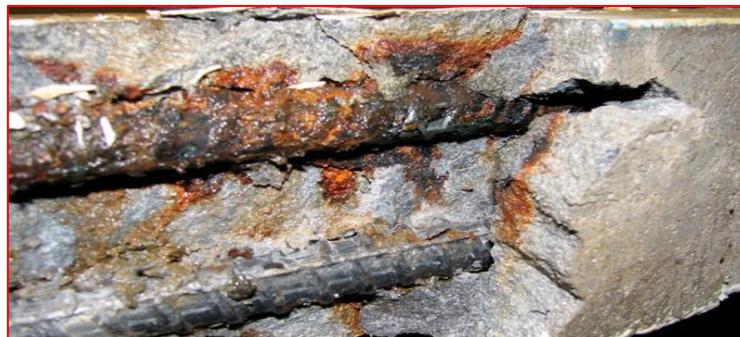
Figure I.10 : phénomène de corrosion des armatures d'un béton armé
