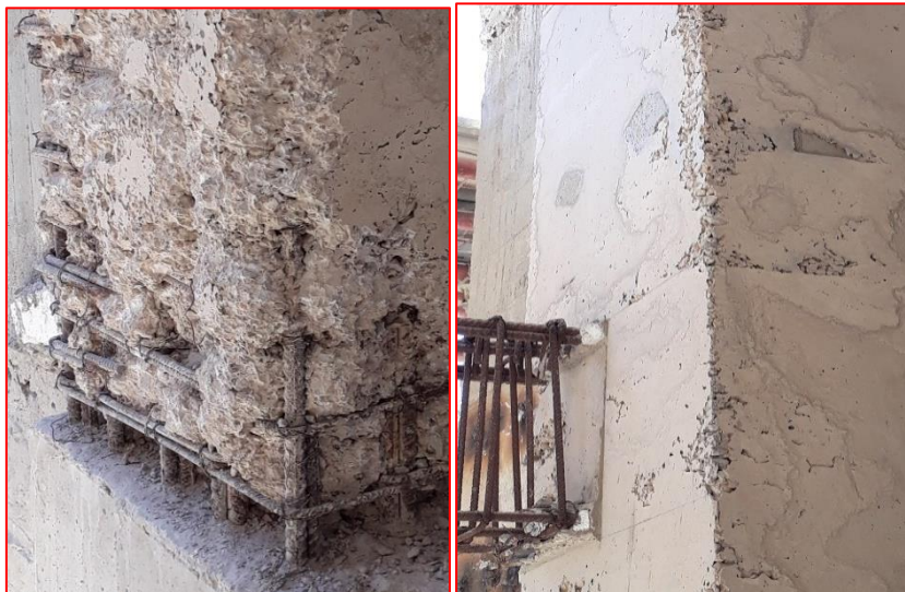
Figure IV.8 : ségrégation profonde et superficielle repérée sur les poteaux
