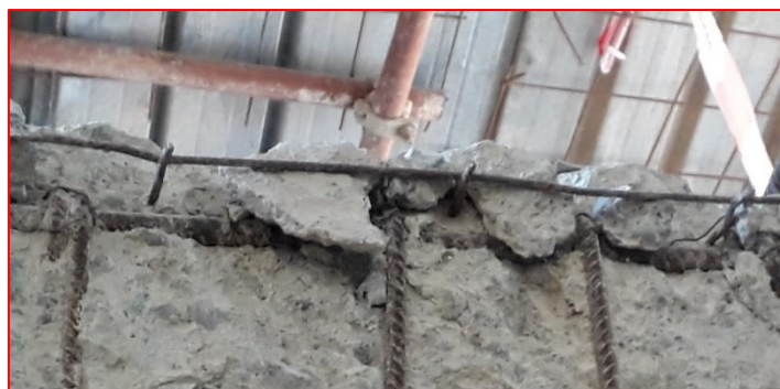
Figure IV.9 : Armatures apparentes par endroit
