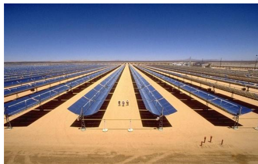
Fig 87 : Panneaux photovoltaïque. Source : Google image.
