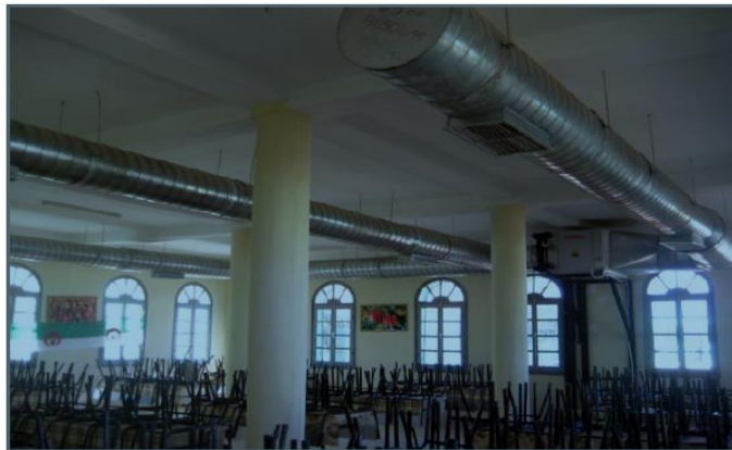
Figure 1.6 : Cantine de l'école primaire alimentée par climatisation géothermique [14].
