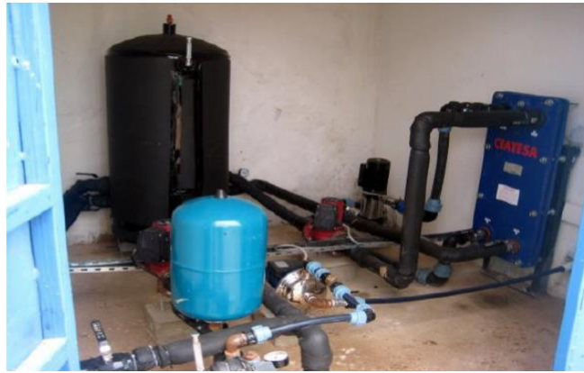
Figure 1.5 : Pompe à chaleur installée dans une école primaire à Saida[14].
