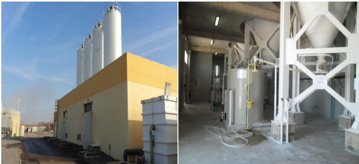
Figure 3.14: Silos de la chaux.
