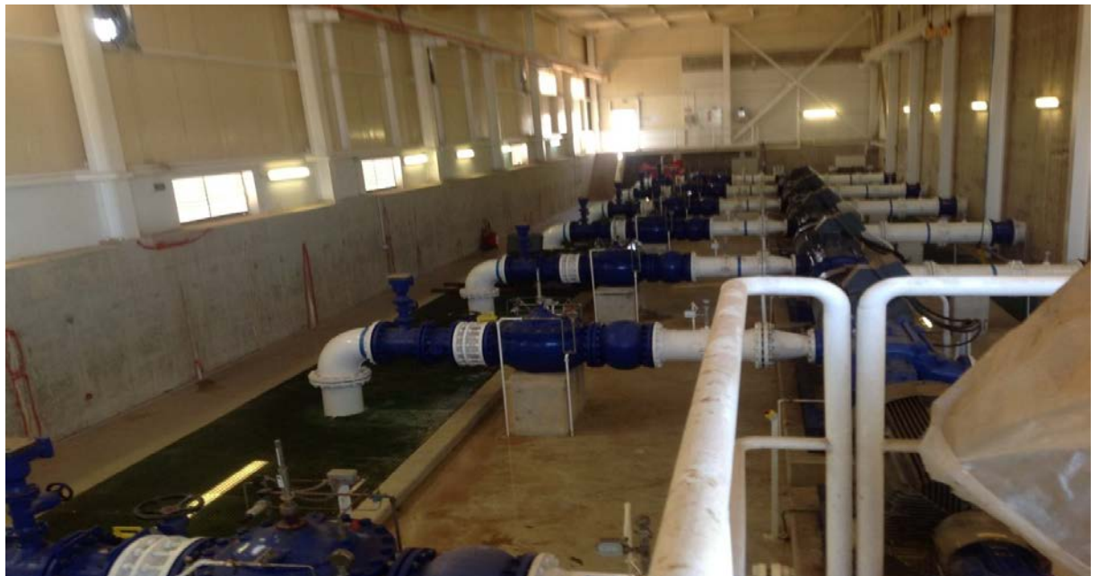
Figure 3.16: Station de pompage d'eau traitée.
