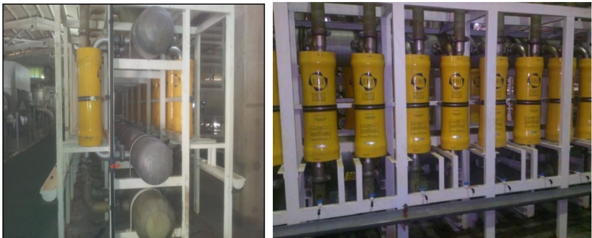
Figure 3.13: Système de récupération d'énergie.
