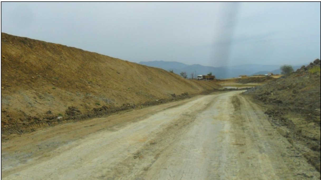
Figure II.12 : Absence de système de drainage en amont et en aval. [24]
