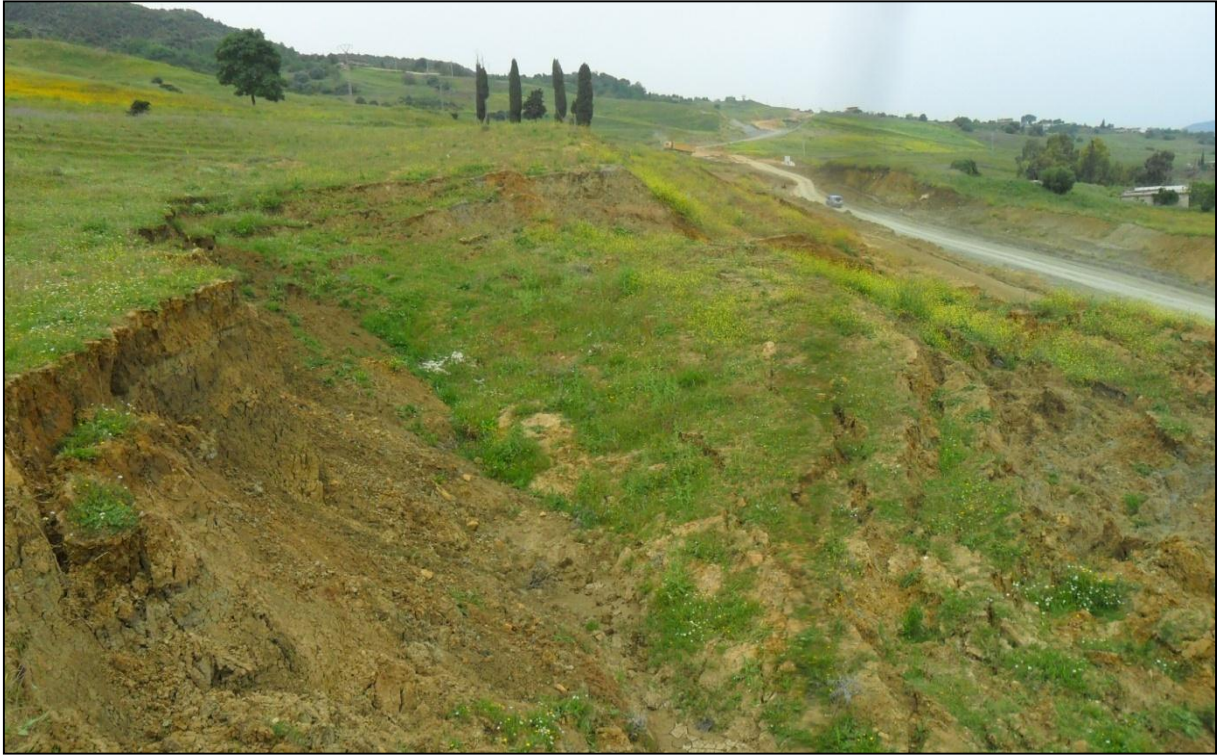
Figure II.9 : Etat décomprimée des argiles caractérisant le talus de déblai. [24]
