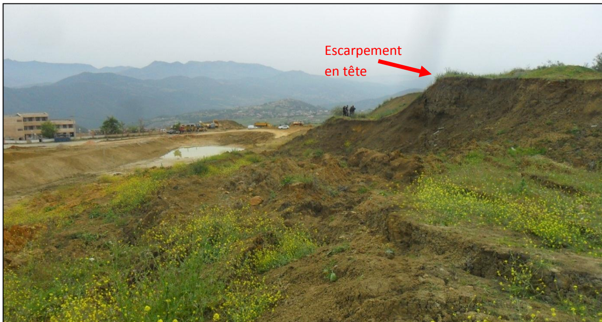
Figure II.8 : Fissures et rupture d'une partie due au ruissellement des eaux pluviales au niveau du talus de déblai de la rive gauche (Escarpement en tête de talus de déblai). [24]
