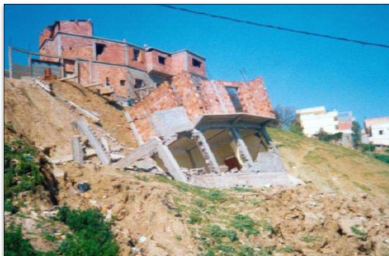
Figure 1.15 : Glissement de Tizi, quartier de Bejaia Basculement d'une habitation [21]
