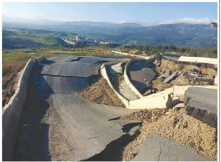
Cas (2) : Glissement de terrain a rampe d'accès de la ville d'Azazga [5]
