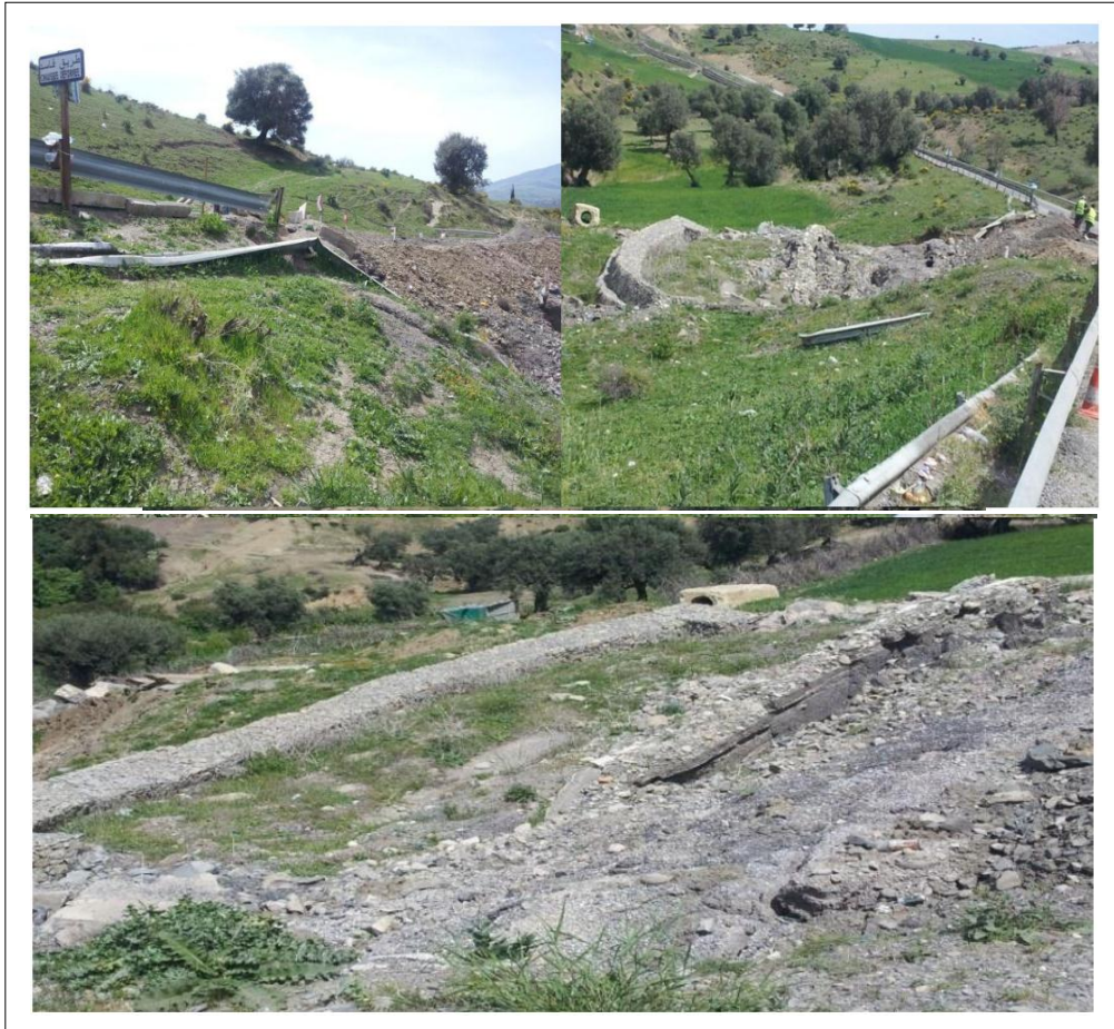
Figure 1.19 : Photos représentant le glissement des débris d'un mur réalisé pour confortement [1]
