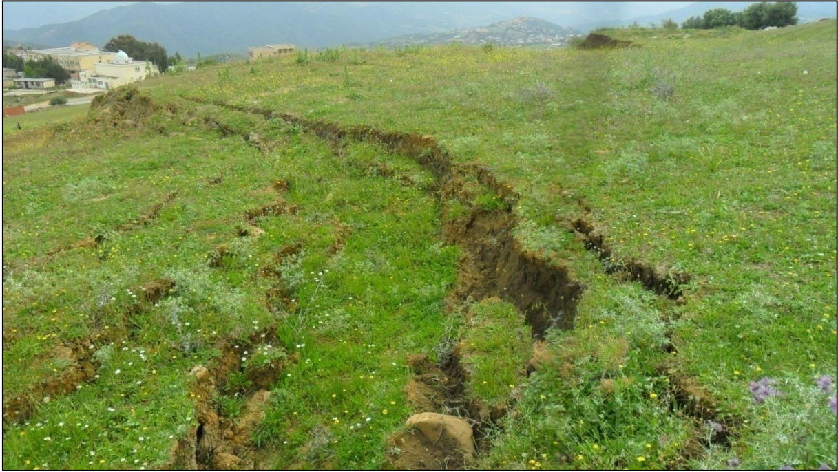
Figure II.11 : Apparition de ligne de glissement au niveau des talus de déblais. [24]
