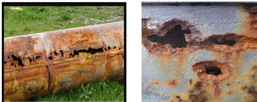
Figure 3.6. Corrosion sous contrainte.
