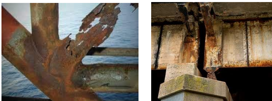
Figure 3.7. Corrosion due à la fatigue
