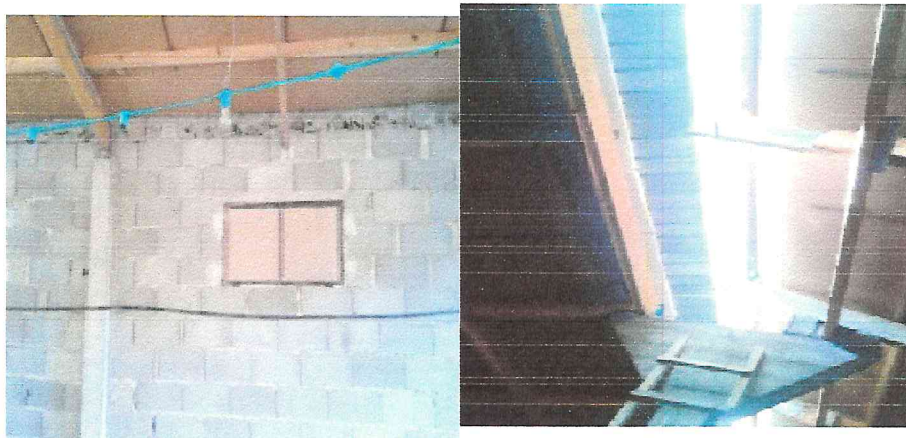
Figure 4 : Système d'aération : fenêtre et lanterneau( photoo personnelle)
