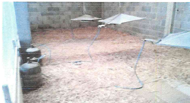
Figure 5 : Système de chauffage (Radian à alimentation gaz butane, photoo personnelle)
