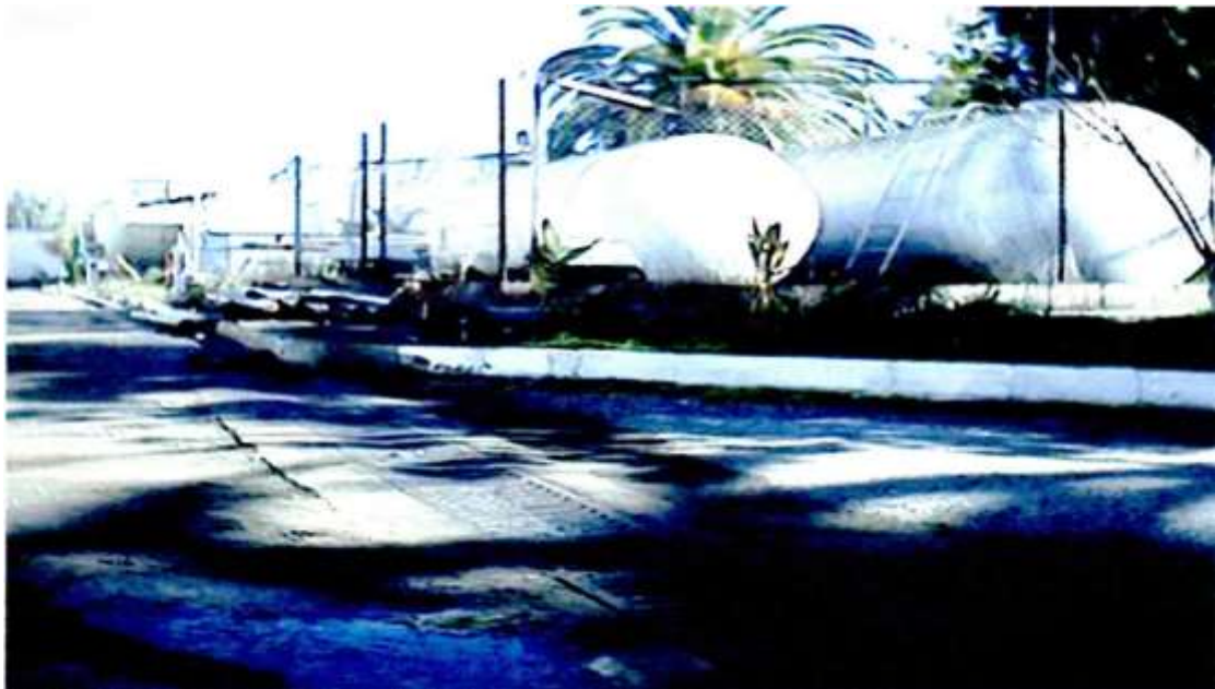
Figure 29 : Réservoirs de stockage de gasoil [8]
