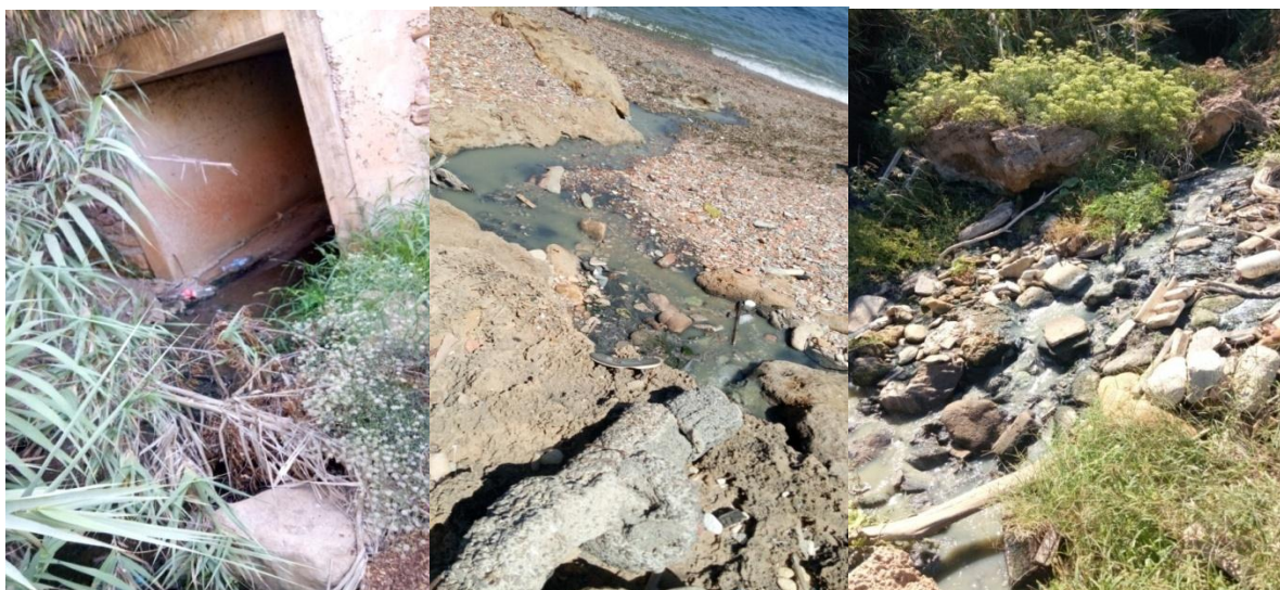
Figure III.4.3. Rejets des eaux usées vers la mer.
