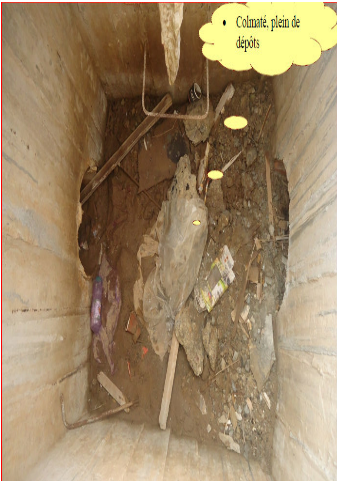
Figure III.4 : Regard colmaté plein de dépôts
