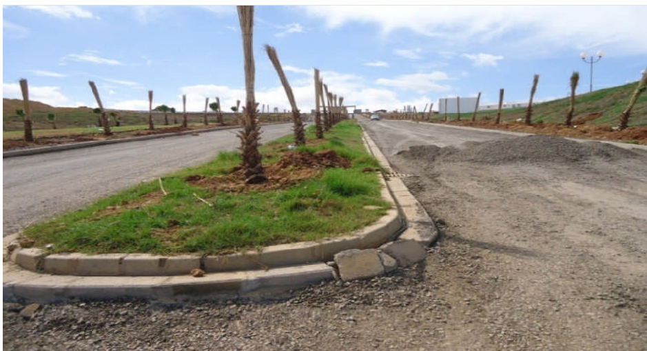
Figure (IV-5) : Inondation du boulevard situé à L'intérieur du centre universitaire.
