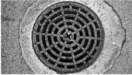
Figure VI.10. Bouche d'égout (source : wikipedia)
