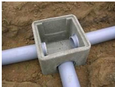
Figure VI.11. Regard de changement de direction (source: Google image)
