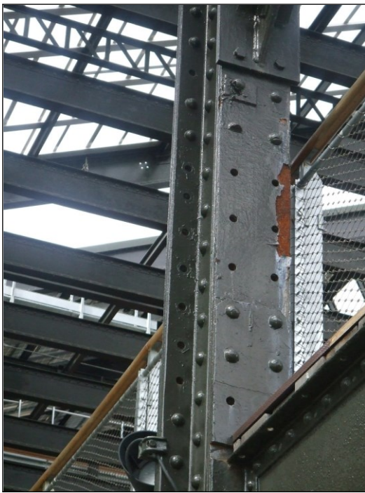
Figure I.19 : Enrouillement et début de corrosion d'un poteau métallique. (18)
