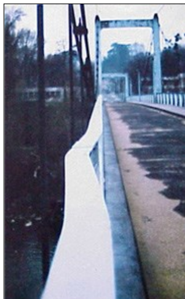
Figure I.35 : Flambement de membrure supérieure de la poutre de rigidité hors du plan, par effet d'un choc. [2]
