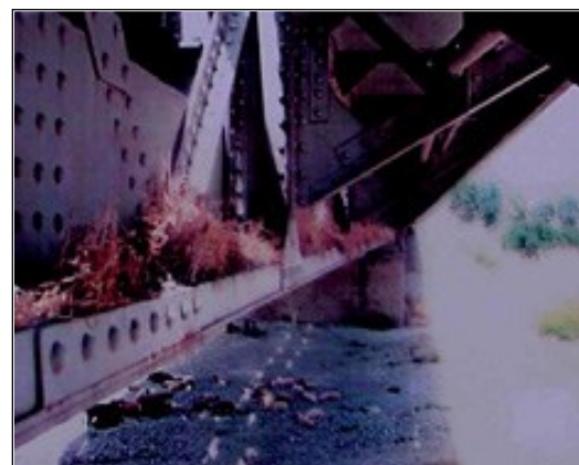
Figure I.24: Renfort des membranes inférieures d'une poutre métallique, formant piège à eau / ou piège à poussière et provoque de la végétation et foyer de corrosion. (23)
