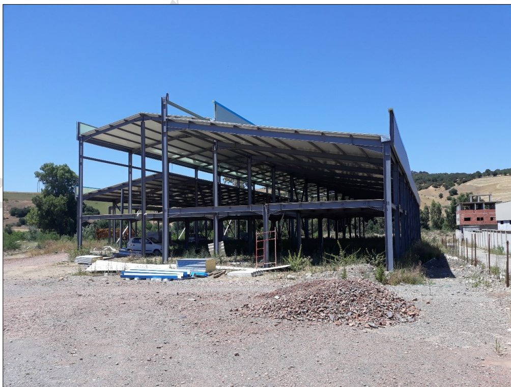
Figure II.10 : Coté de façade de la structure existante prévue pour un centre frigorifique.
