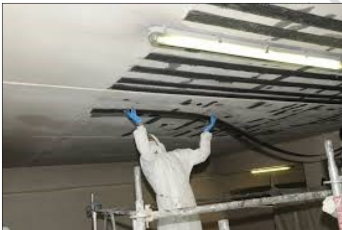
Figure I.68: Confortement d'une dalle fléchie en BA, par matériaux composite (PRF). (52)
