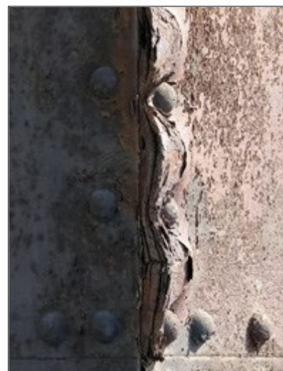
Figure I.18 : Corrosion foisonnante entrainant une importante traction sous têtes des rivets. (17)
