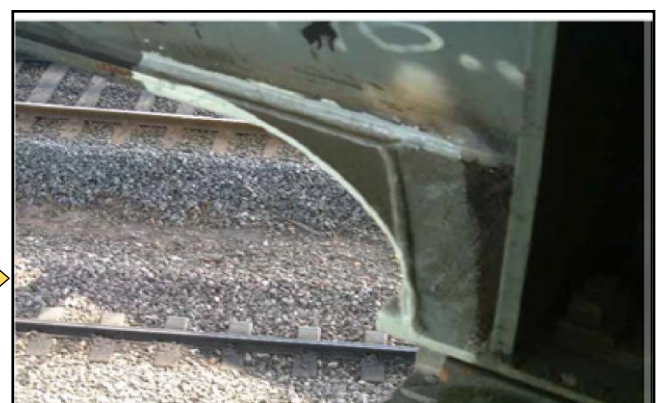
Figure I.47 : Réparation avec gousset d'épanouissement. [2]
