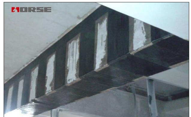
Figures I.73: Confortement d'une poutre métallique d'une dalle mixte, par matériaux composite (PRFC). (57)
