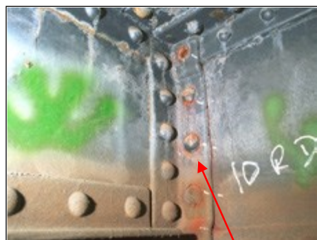
Figure I.29 : Différents stades de déconsolidation d'un assemblage rivets. (27)
