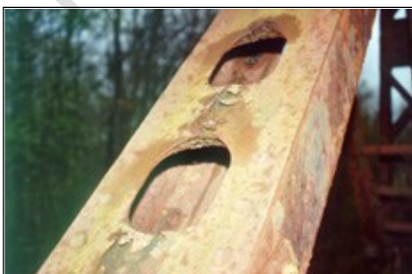
Figure I.23 : Corrosion, foisonnement sur dé doublure sur une poutre caisson élégie. (22)
