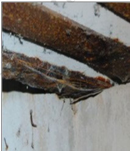
Figure I.17 : Dégradation avec écrasement de la zone d'appuis d'une poutrelle, affaiblissement par la corrosion. (16)
