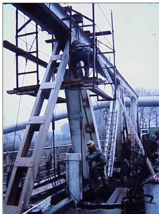
Figure I.41 : Remplacement d'un montant d'une poutre treillis d'un pont – dispositif provisoire de reprise des efforts par barres de brêlage. [2]
