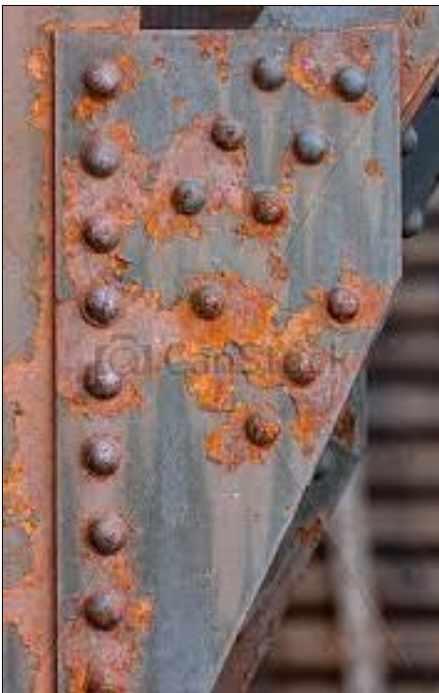
Figure I.21 : Enrouillement et début de corrosion d'un ancien gousset des années 1970. (20)
