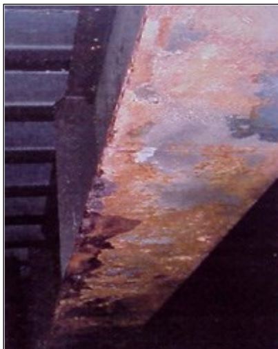
Figure I.15 : Enrouillement et début de corrosion d'une poutre métallique. (14)
