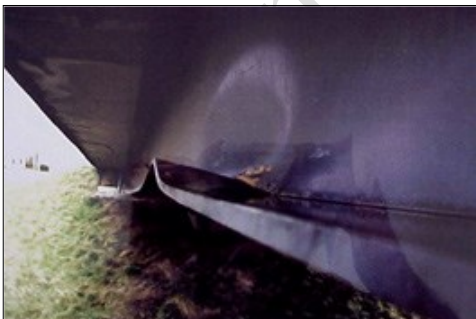
Figure I.34 : Choc de véhicule sur ouvrage moderne – déformations de la membrure inférieure et de l'âme de poutre. [2]
