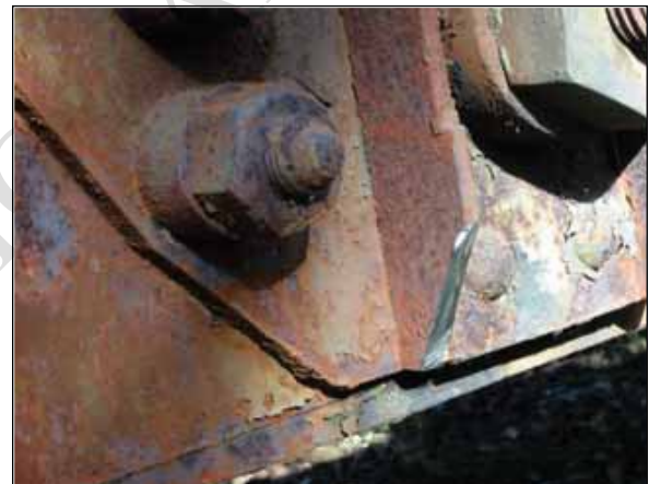
Figure I.16 : Corrosion au niveau du system d'assemblage. (15)
