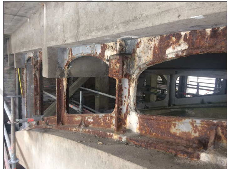
Figure I.22 : Dégradation par corrosion d'une poutre-raideur dans un pont à structure mixte. (21)
