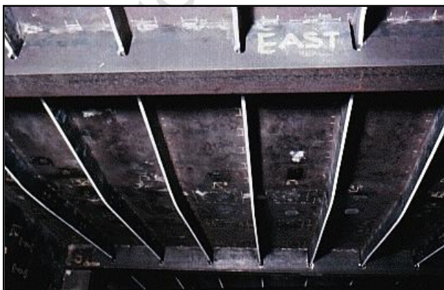
Figure I.13 : Diversement des solives sous effet de forte charge mise sur plancher. (12)
