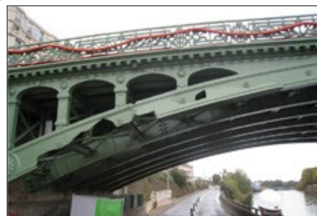
Figure I.27 : Choc d'un véhicule sur un arc d'un pont en fonte de 1903. (25)
