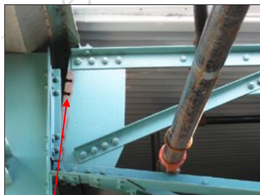
Figure I.31 : Rupture par accumulation des contraintes et dépassement des efforts diamétrales sur une charpente. (29)
