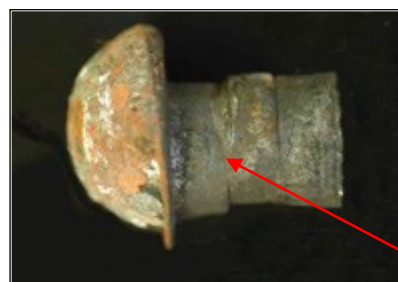
Figure I.32 : Effet de cisaillement sur un rivets métalliques retiré d'un assemblage déconsolidé. (30)
