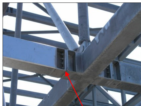
Figure I.30 : Jeu d'assemblage provoqué par un mauvais montage sur site. (28)
