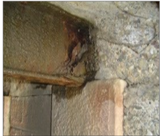
Figure I.20: Dégradation avec écrasement de la zone d'appuis d'une poutre encastrée dans un mur porteur, affaiblissement par la corrosion. (19)
