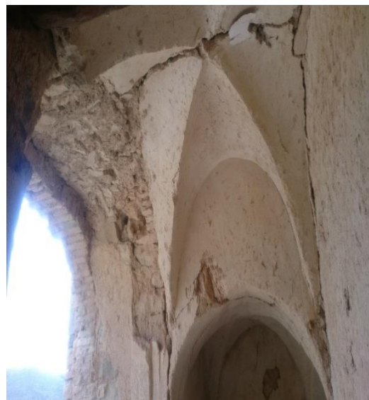
Figure 2. 34 Fissures dans la voûte d'arrêt.
