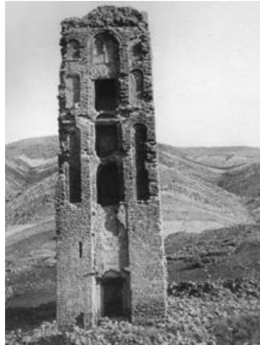
Figure 2.32 Vue en façade (état dégradé).
