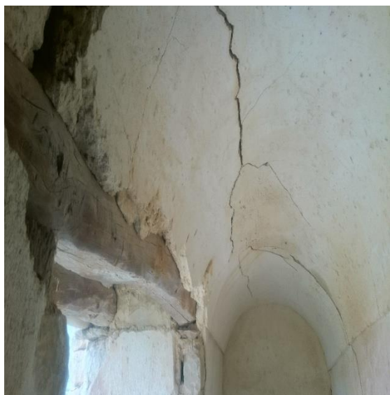
Figure 2. 33 Fissures dans la voûte longitudinale.
