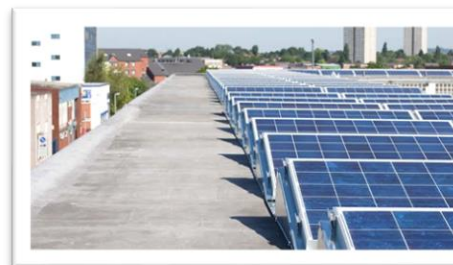
Figure 86 : Les panneaux photo voltaïques sur les toitures des bâtiments
