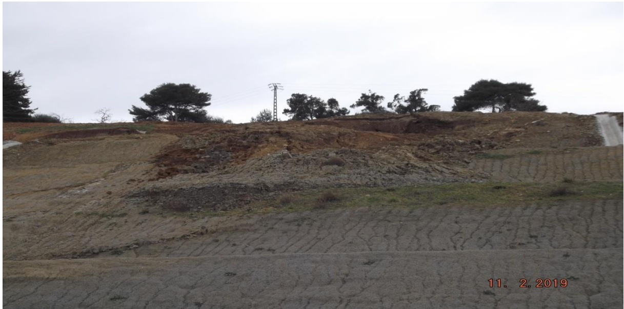
Photo le glissement de terrain de PK12
