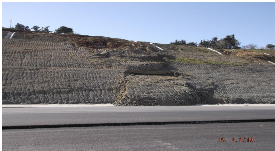
Photo II.3 : Ecoulement d’une masse de terre. [6]
