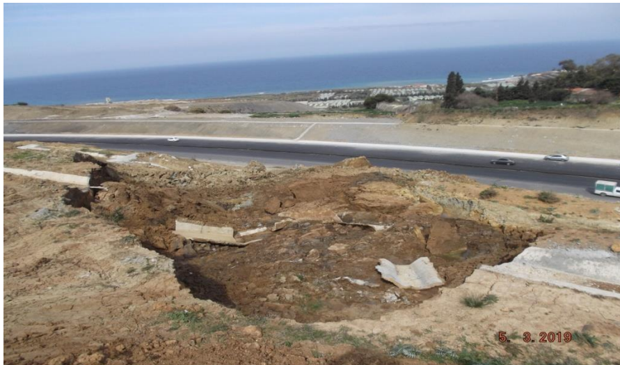
Photo II.4 : Effondrement de terrain. [6]
