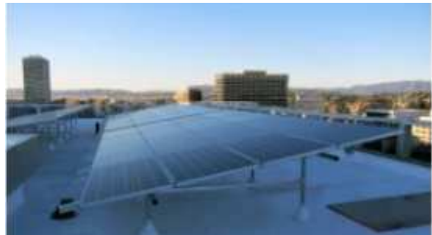
Figure 9: Les panneaux photovoltaïques sur le toit du palais de justice de Los Angeles
