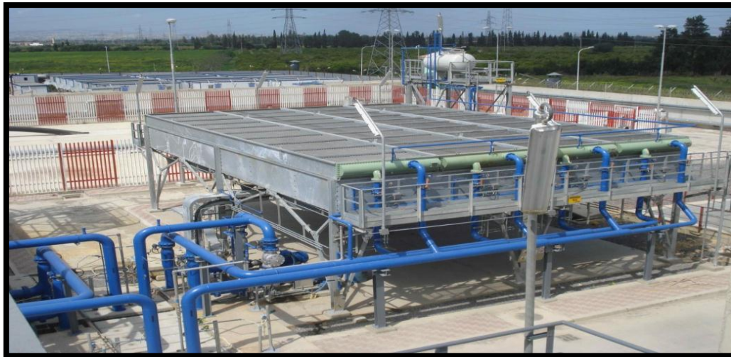
Figure 2.1 : Système de refroidissement NORIA
