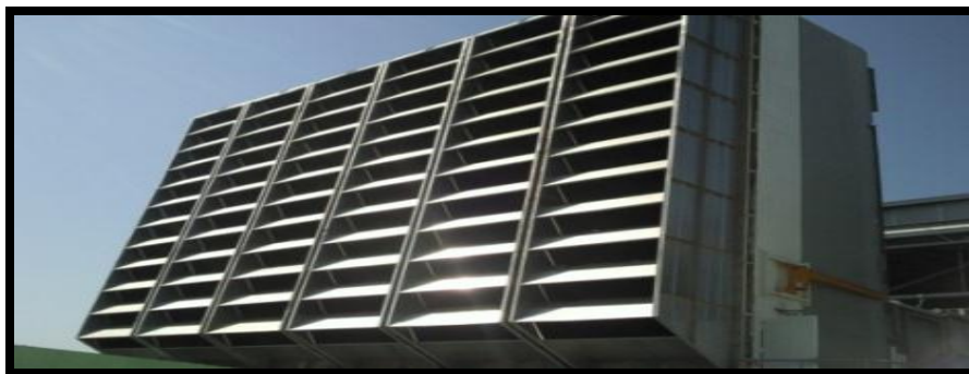
Figure 1.9 : Système de filtration d'air
