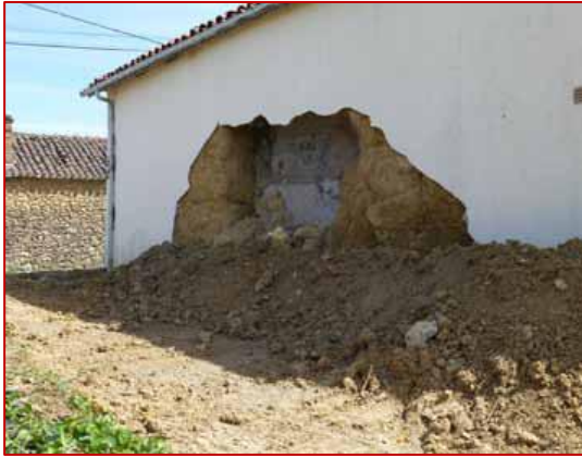
Figure 30: Effondrement d'un bout de mur en terre fermé entre un enduit ciment et des blocs de parpaing
