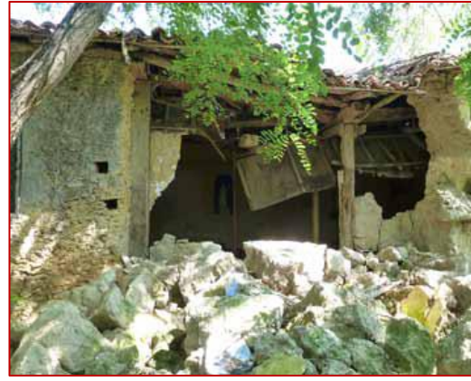
Figure 31: Effondrement d'un mur à cause d'une toiture abîmée (poussée de la charpente et infiltration d'eau)
