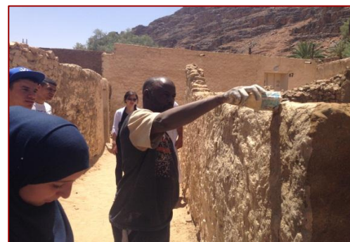
Figure 57: pose une peinture de liquide de (Tabarek + eau) sur la paroi de mur
