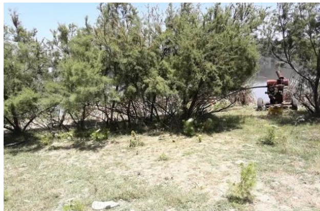
Figure 07 : Pompe émergée au niveau de la rive Ouest (BRAHIMI, 2018)
