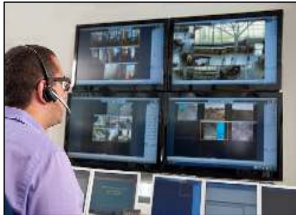
Figure III-61: Moniteur de surveillance .Source : Google image.
