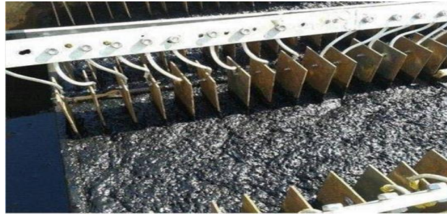
Figure II-6 Station de traitement par l'électrocoagulation
