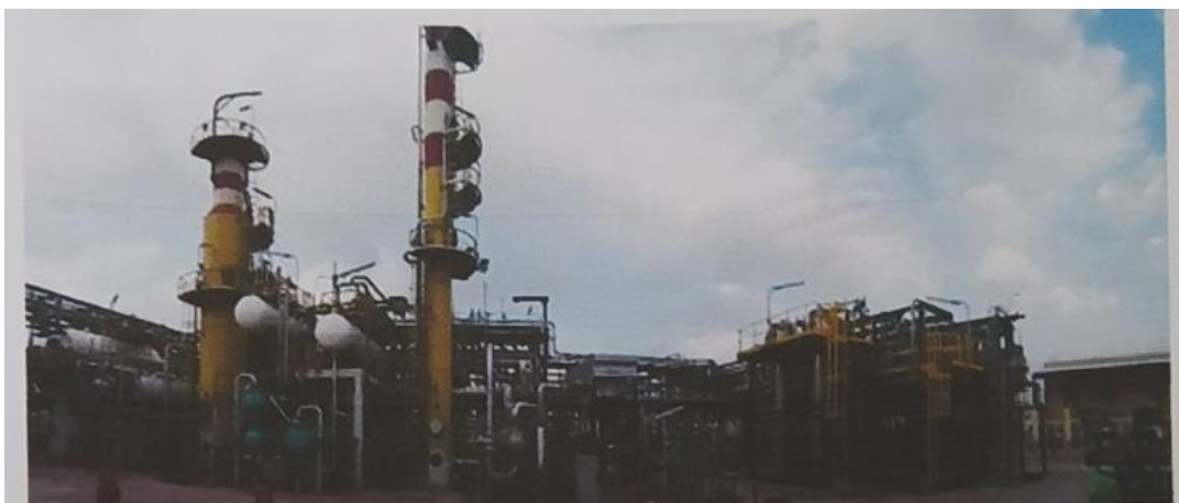
Figure I.3 : Unité de Gaz-Plant (U300).
