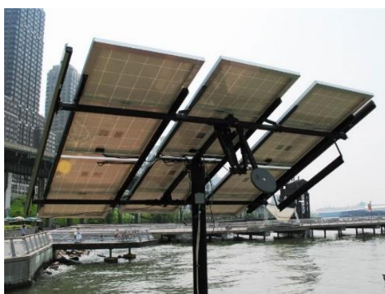
Figure 64 : montre un panneau photovoltaïque.
