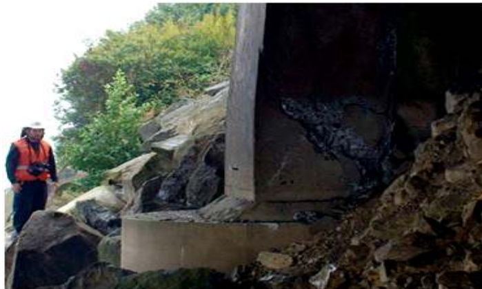
Figure I-4 : Rupture des piles par cisaillement [4]
