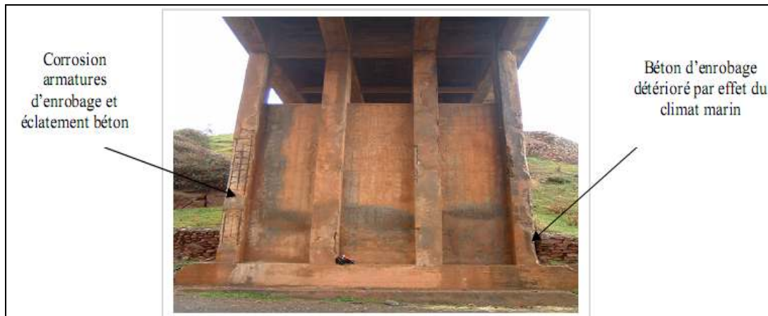
Figure I-35 : Vue des dégradations apparentes sur la pile [25]
