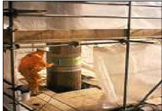
Figure I-23 : Enveloppement total de la pile [16]
