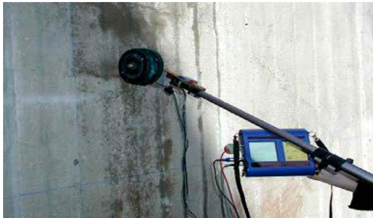
Figure I-11 : Roue électrode détection des armatures au radar [7]
