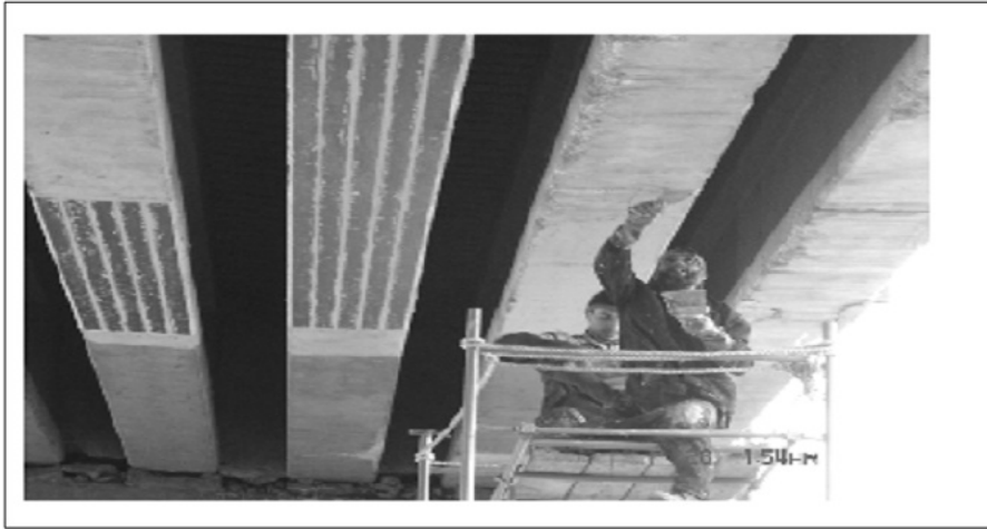
Figure I-34 : Pose de tissu en fibres de carbone sur les poutres du tablier [24]
