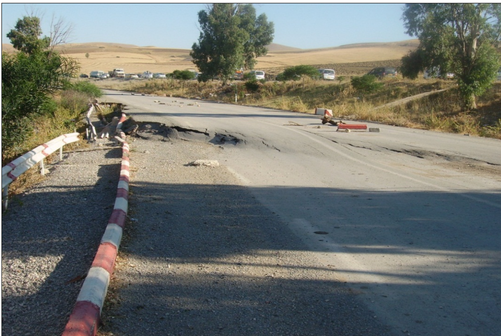
Figure 72 : Photo de la chaussée « allant vers El-Khroub ».
