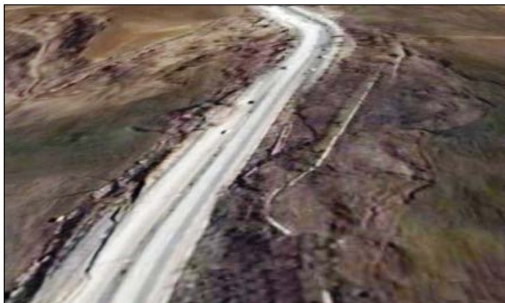
Figure 16: Fissure longitudinales dans la route de Massinissa.
