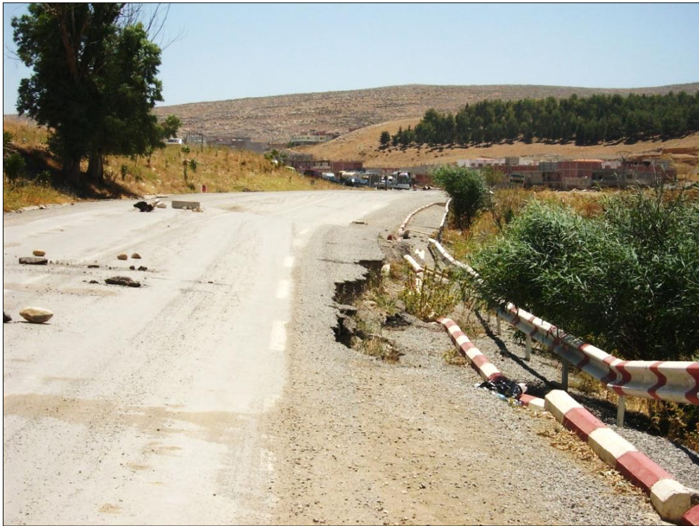
Figure 73 : Photo de la chaussée « allant vers sigus ».
