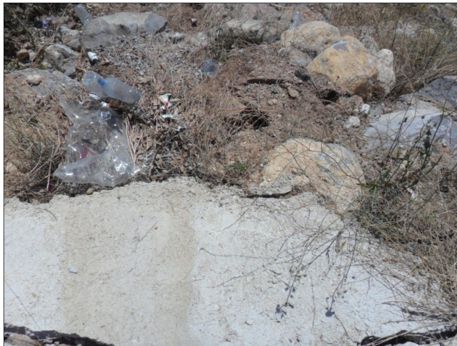
Figure 76 : Fissures à la tête du talus .
