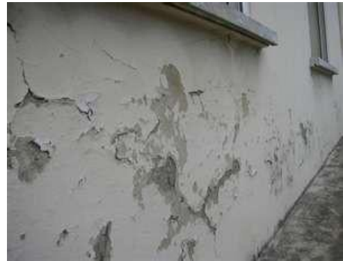
Figure 34 : Détérioration des matériaux par humidité
