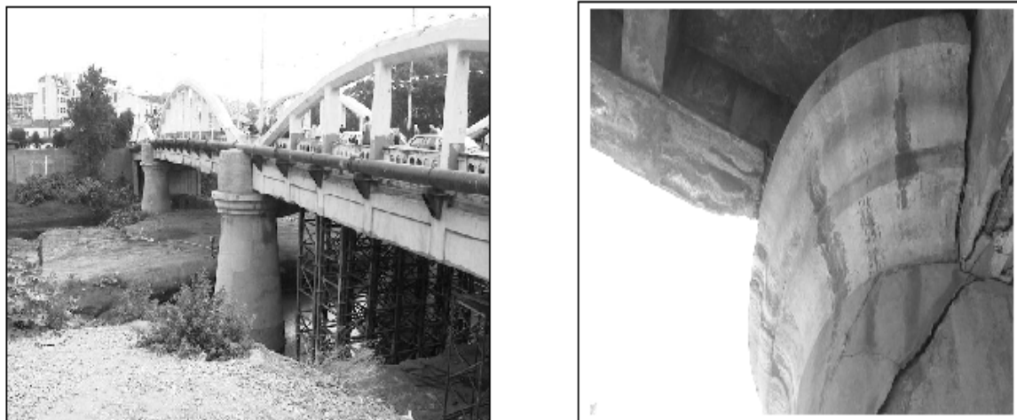
Figure II.33: Pont blanc d'El Harrach (Alger) avec dégradation au niveau de la pile [13]
