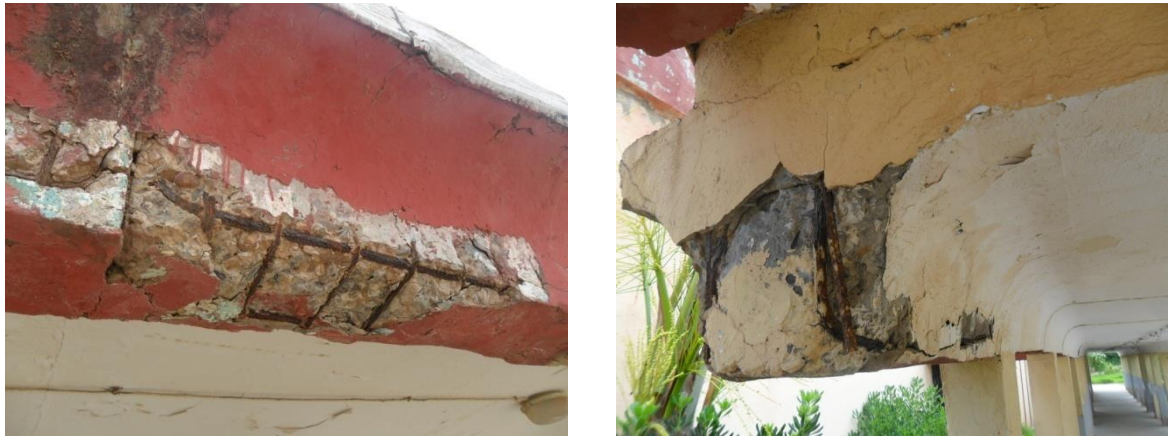
Figure 3.53 : Fissures des poutres des galeries avec éclatement de béton de l'enrobage et corrosion de l'armature.
