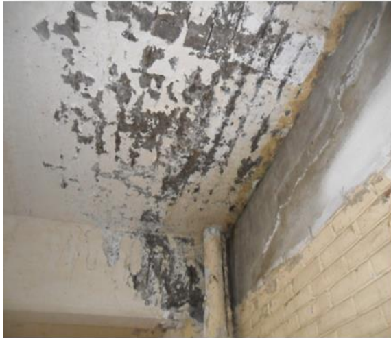
Figure 3.49 : Altération du béton d'enrobage de dalle non cloisonnée à proximité de conduites d'évacuation des eaux usées.
