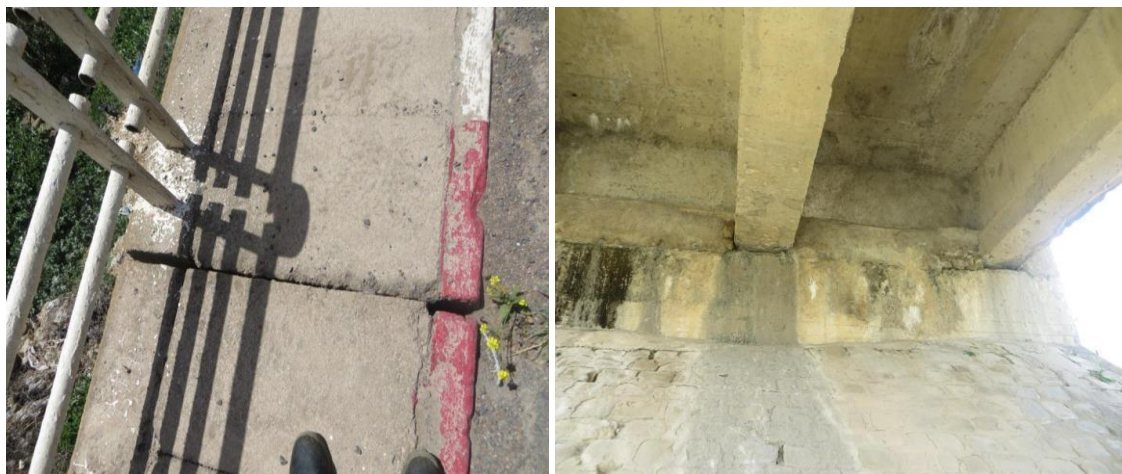
Figure 3.89 : Manque joint de trottoir côté amont et aval.
