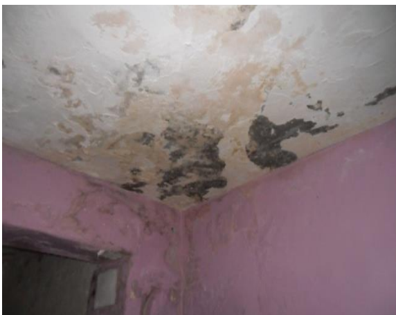
Figure 3.11 : Infiltration, détérioration des enduits et taux d'humidité très élevé.
