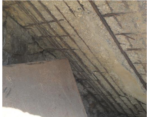
Figure 3.15 : Mise à nu des armatures et corrosion avancée.
