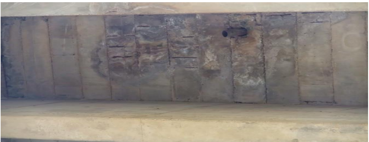
Figure 3.80 : Efflorescences, éclatement de béton et dénudement aciers sur intrados de hourdis au droit des sorties d'avaloirs.
