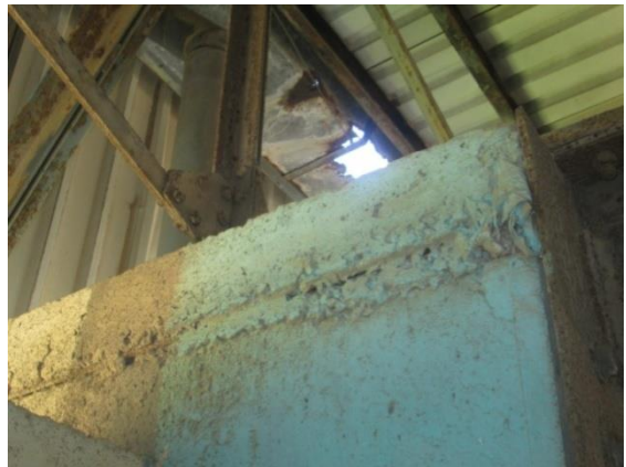
Figure 3.59 : Ségrégation du béton, poteaux.
