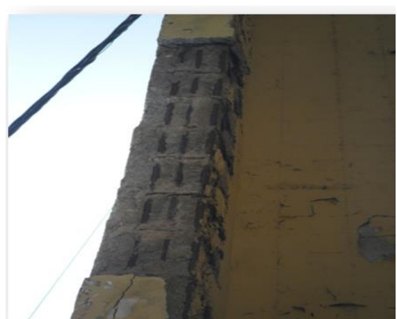
Figure 3.48 : Epaufures du béton et corrosion des armatures des poteaux.
