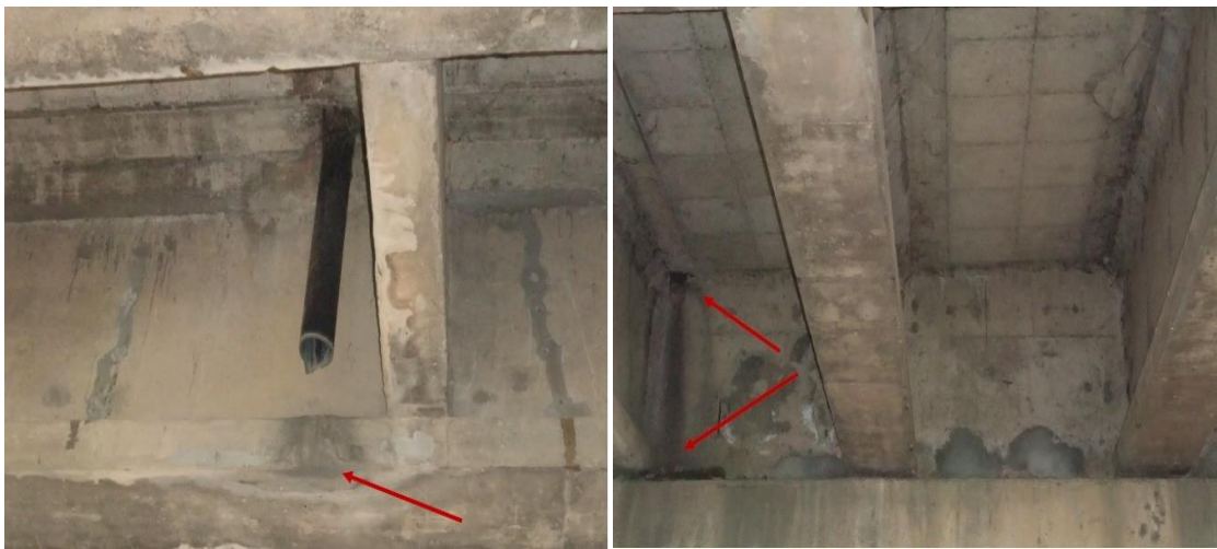
Figure 3.84: Sortie d'avaloir non prolongée.
