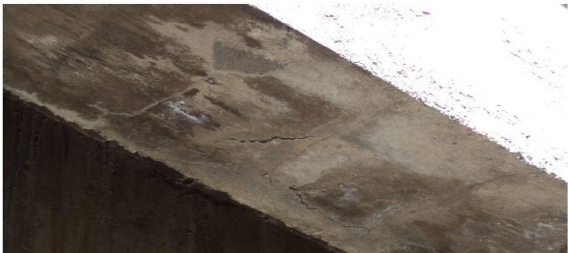
Figure 3.71 : Eclatement du béton sous-face de poutres de rive.
