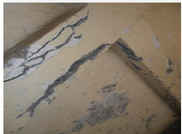
Figure 3.42 : Eclatement du béton des éléments de contreventement en X
