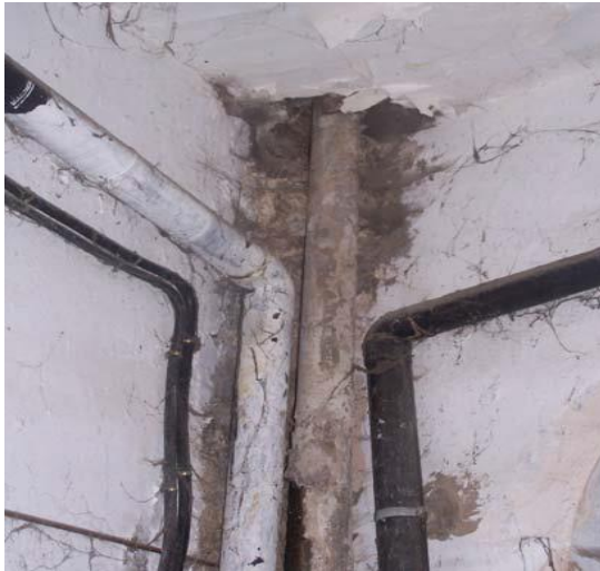
Figure 1.30 : Mauvais branchement des descentes d'eau et fuite d'eau [2].
