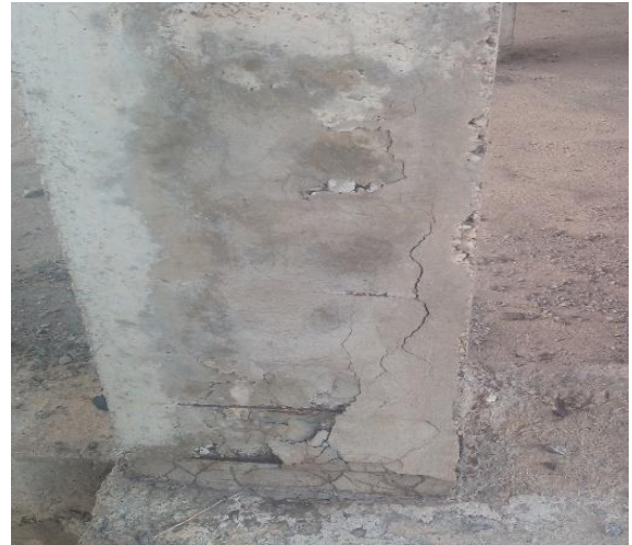
Figure 1.23 : Fissure d'un poteau.
