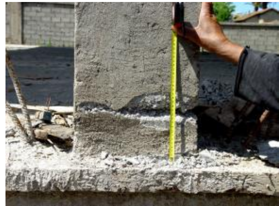
Figure 1.42 : Talonnette de 10 cm en mortier de mauvaise qualité et reprise de béton[48].
