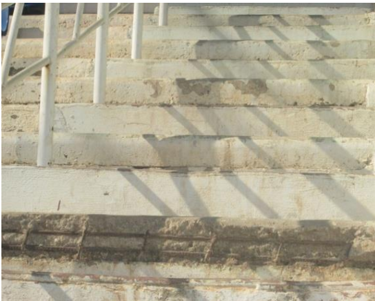
Figure 3.58 : Corrosion et éclatement du béton, tribune.
