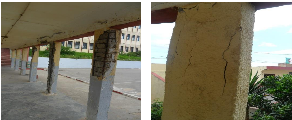
Figure 3.54 : Fissures des poteaux des galeries avec éclatement de béton de l'enrobage et corrosion de l'armature.
