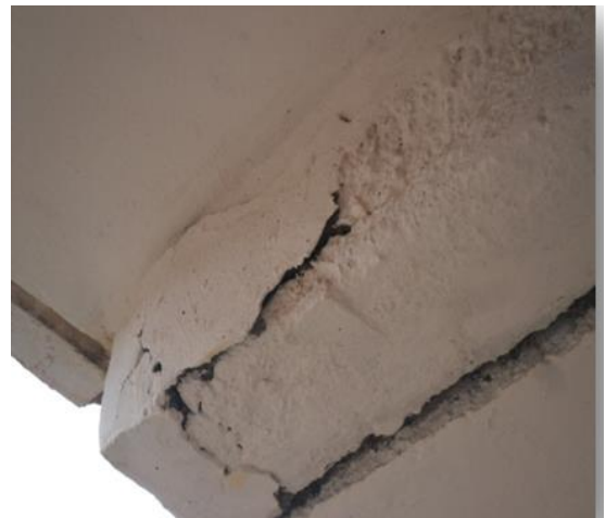
Figure 3.46 : Fissuration et éclatement du béton des poutres consoles.
