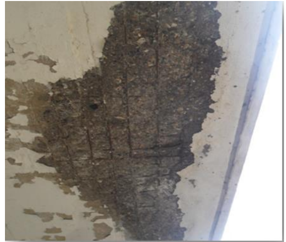
Figure 3.50 : Perte d'enrobage en sous-face des dalles de coursives provoquant de la corrosion.
