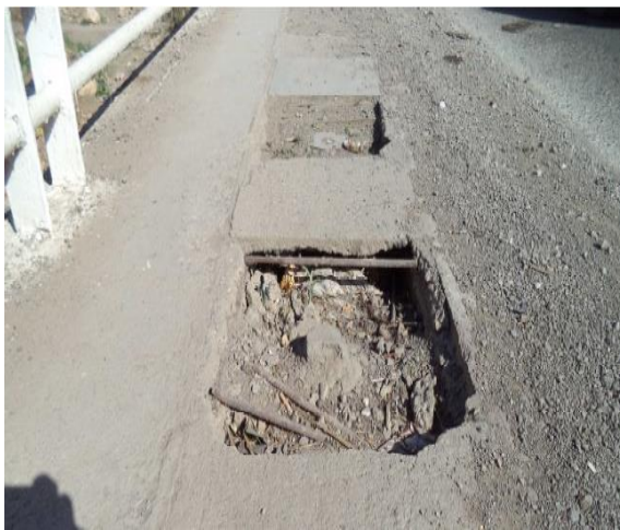
Figure 3.64 : Vue de trottoir rompu.
