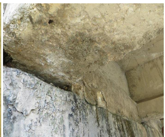
Figure 3.95 : Épaufure de poutre.
