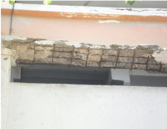
Figure 3.7 : Epaufures du béton et corrosion des armatures.
