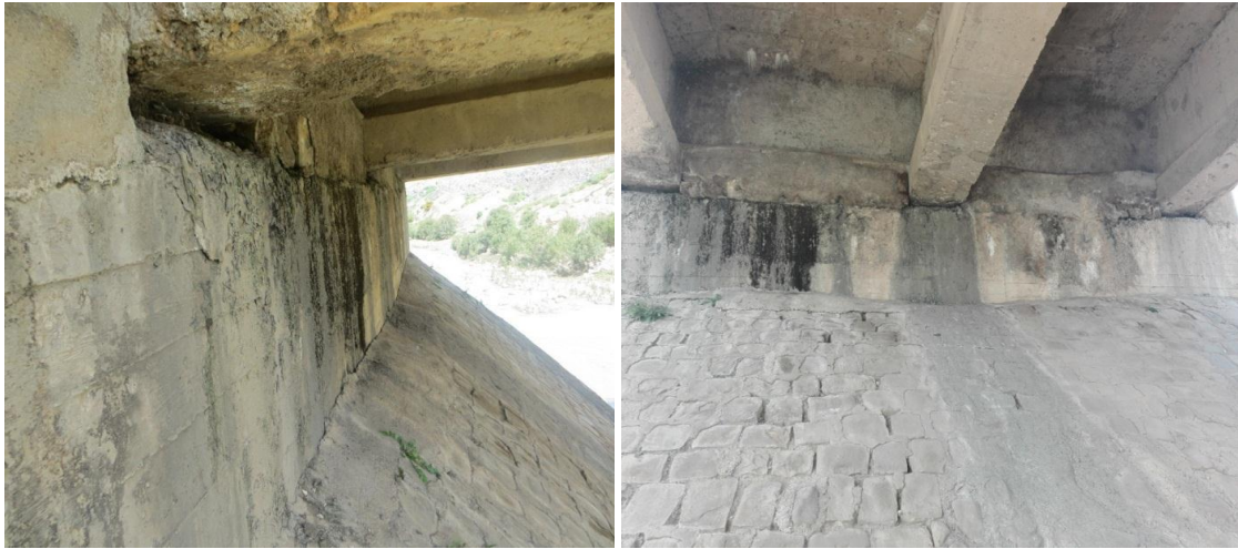
Figure 3.91 : Salissures jaunes sous face de la dalle et noires sur le mur de front.
