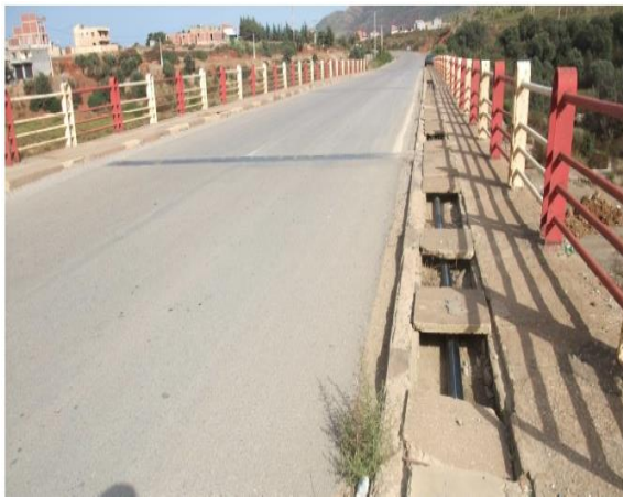
Figure 3.73 : Dalles de trottoir rompues ou disparues.
