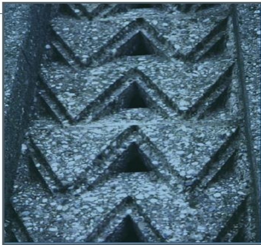
Figure 1.26 : Erosion d'une partie de la laitance d'un élément de claustras
