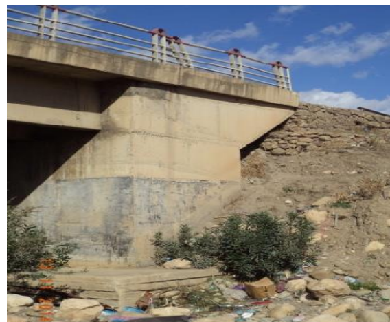
Figure 3.67 : Affouillement de la semelle.
