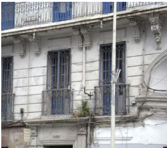
Figure 1.28 : Façades en état délabrés, désordres sur les balcons [2].
