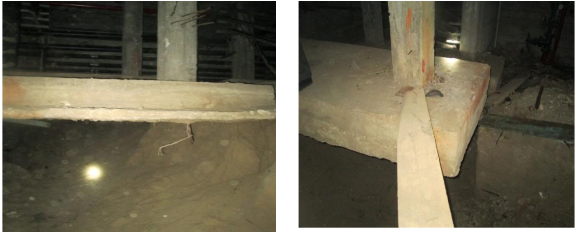
Figure 3.36 : Absence de plate forme et départ des particules sous deux fondations provoquant l'affouillement des deux fondations.
