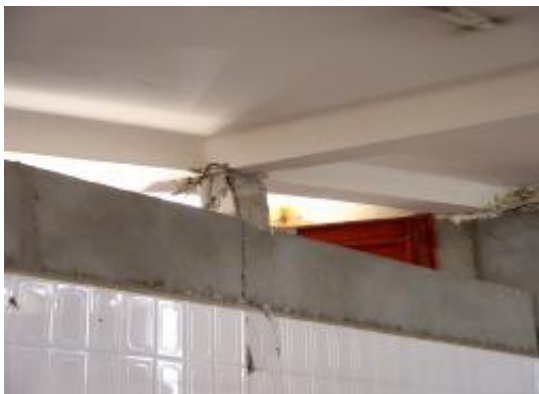
Figure 1.43 : Détail de destruction à cause du fonctionnement en poteau court [48].
