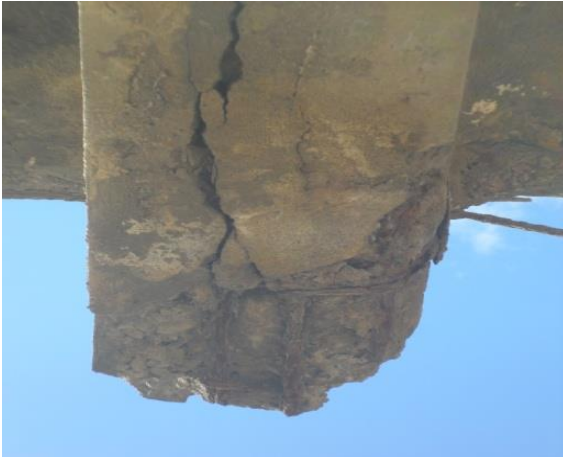
Figure 3.14 : Epaufures du béton et fissurations.
