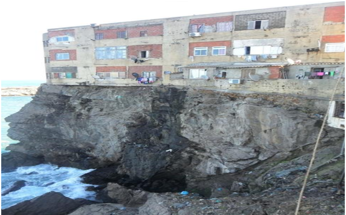
Figure 3.13 : Vue générale de la bâtisse Rais Hamidou, Milieu marin agressif.
