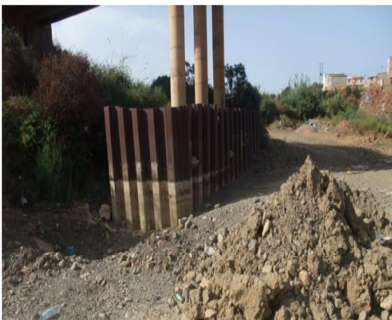
Figure 3.75 : Affouillement (pile rive gauche)
