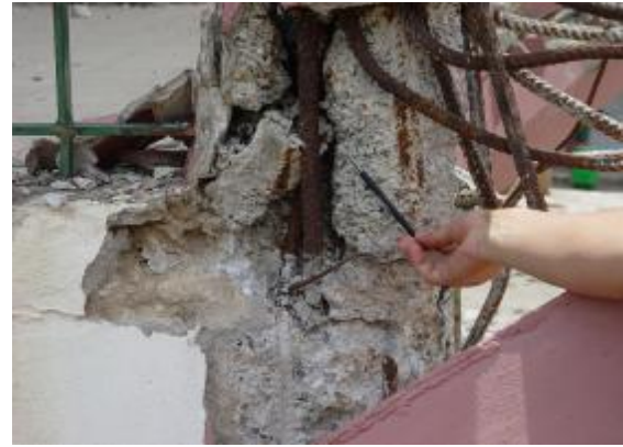
Figure 1.46 : Corrosion des armatures et mauvaise qualité du béton [48].
