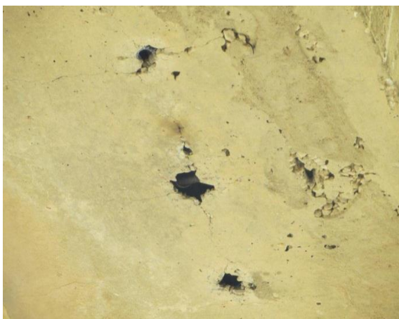
Figure 3.94 : Ségrégation de poutre.
