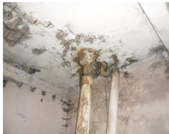
Figure 3.12 : Détérioration du réseau d'assainissement.
