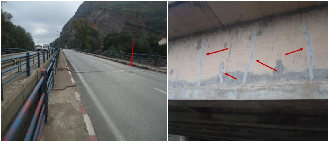
Figure 3.82 : Joint de chaussée détérioré.
