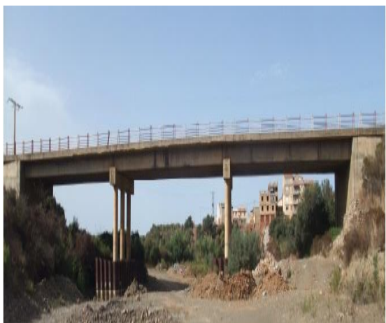
Figure 3.76 : Les souillures d'infiltration sur les joues des poutres.
