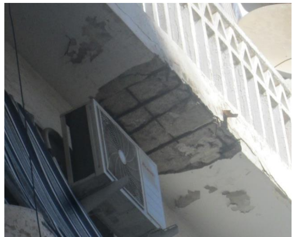
Figure 1.27 : Epaufrures et corrosion Bâtiment colonial, Alger.
