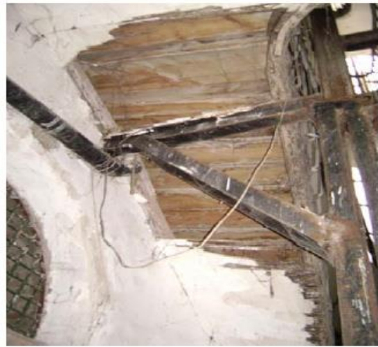
Figure 1.31 : Dégradation de l'escalier et renforcement provisoire[2]
