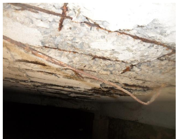
Figure 3.6 : Rupture du ferrailage des planchers des vides sanitaires.
