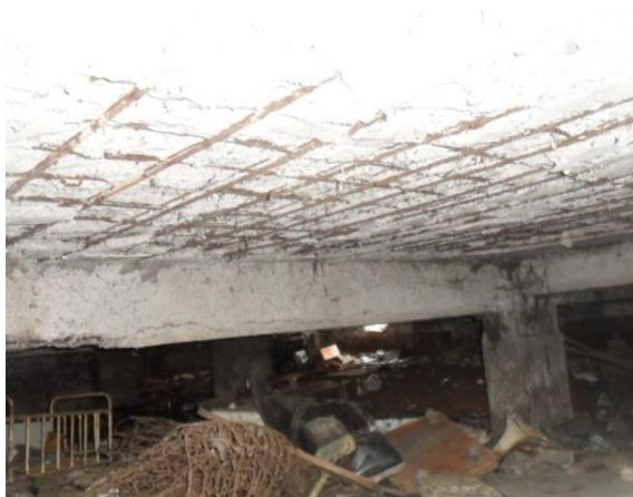
Figure 3.5 : Perte d'enrobage en sous faces des planchers dans les vides sanitaires.
