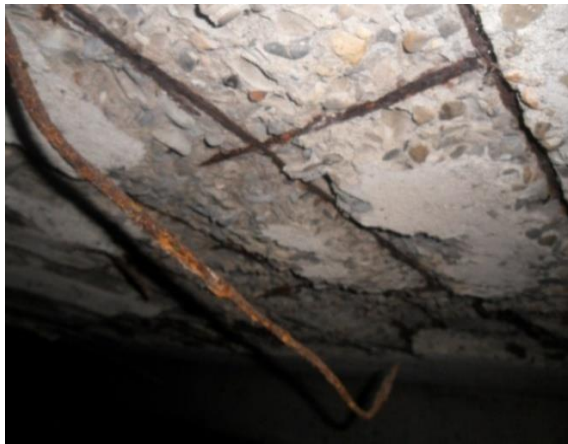
Figure 3.9 : Perte de masse des sous Faces des dalles et rupture du ferrailage
