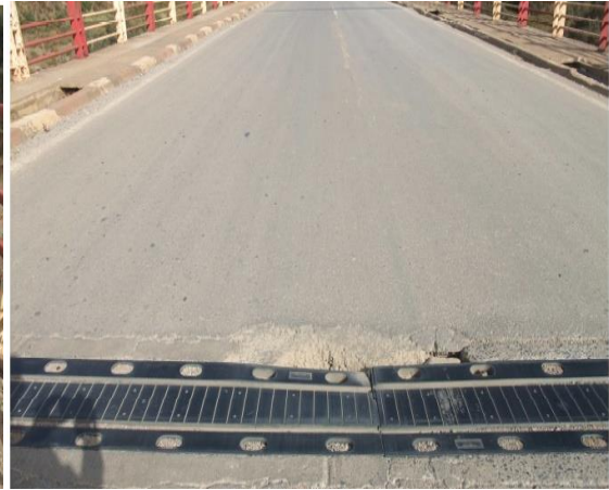
Figure 3.74 : Joint de chaussée affaissé (pile rive gauche).
