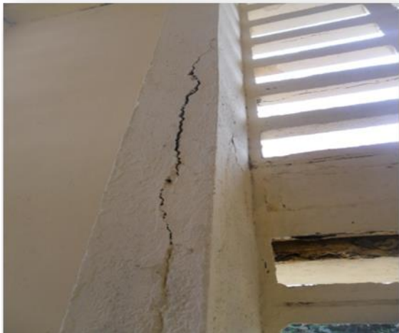
Figure 3.43 : Fissurations verticales au droit des poteaux de la cage d'escalier.
