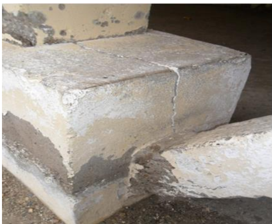
Figure 3.41 : Fissurations observées à la base des poteaux (coté latéral gauche).
