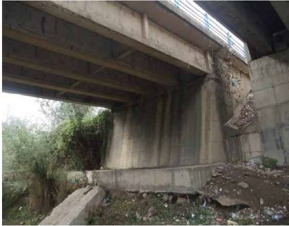
Figure 3.86 : Début d'affouillement de la semelle et végétation sur chevêtre.
