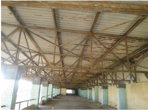
Figure 3.61 : Corrosion de la charpente métallique.
