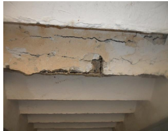
Figure 3.10 : Fissuration au niveau de l'escalier et corrosion.
