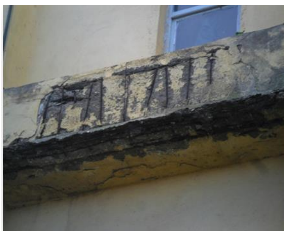
Figure 3.47 : Epaufures du béton et corrosion des armatures des poutres.
