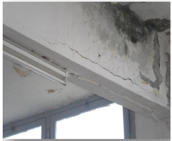
Figure 3.44 : Fissuration horizontale au droit d'un élément poutre au 2 ème étage.
