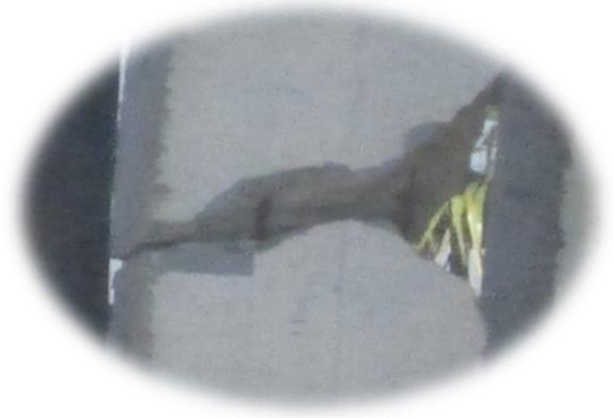
Figure 3.62 : Cisaillement de poteau
