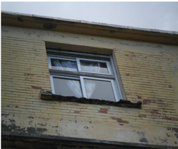
Figure 3.45 : Fissuration et éclatement du béton de l'appui de fenêtre.
