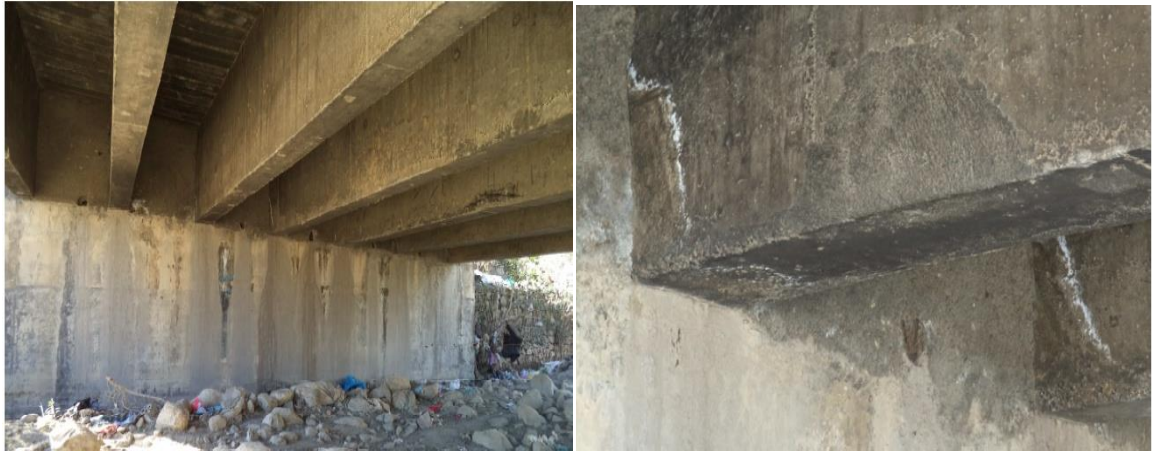
Figure 3.68 : Infiltrations sur mur de front. Figure 3.69 : Efflorescence et trace d'humidité.
