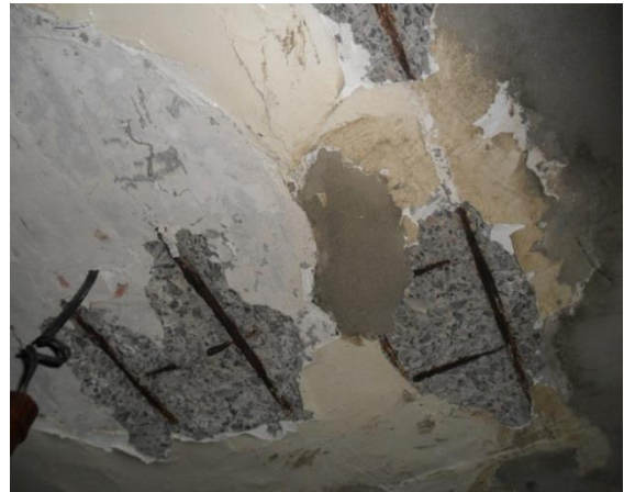
Figure 3.8 : Délamination du béton en sous faces des dalles
