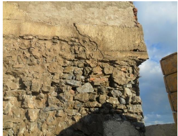
Figure 3.17 : Perte de masse au niveau des contreforts en pierre.
