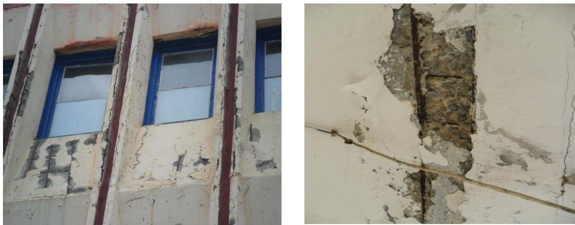
Figure 3.55 : Epaufrures au niveau des panneaux préfabriqués et corrosion des armatures.
