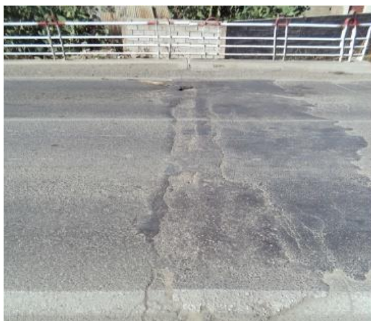
Figure 3.66 : Absence de joint de chaussée.
