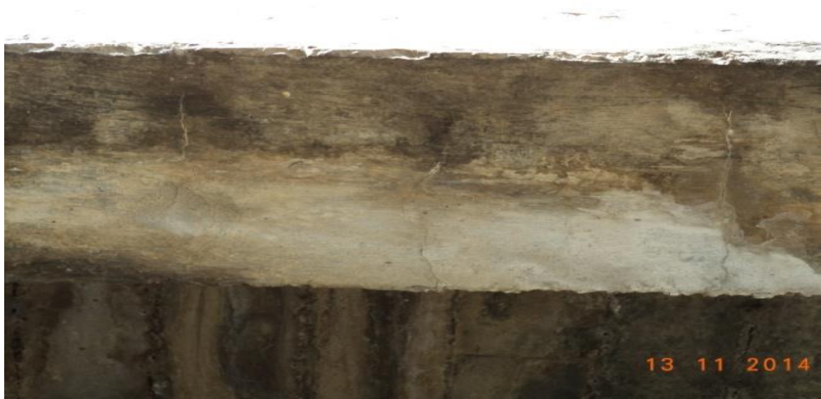
Figure 3.70 : Fissures transversales sur poutres de rive.
