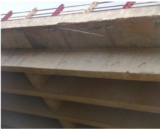
Figure 3.77 : Epaufures et dénudement des aciers de corniche.
