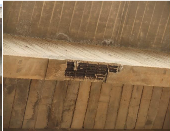
Figure 3.78 : Corrosion sur poutre de rive.
