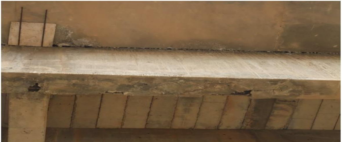
Figure 3.79 : Ouverture du joint longitudinal intrados de trottoir/poutre de rive et éclatement de béton avec corrosion des aciers.
