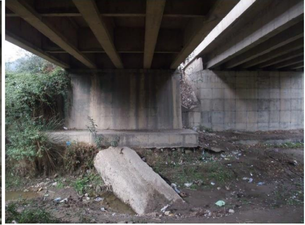
Figure 3.87 : Affouillement de la pile rive gauche.
