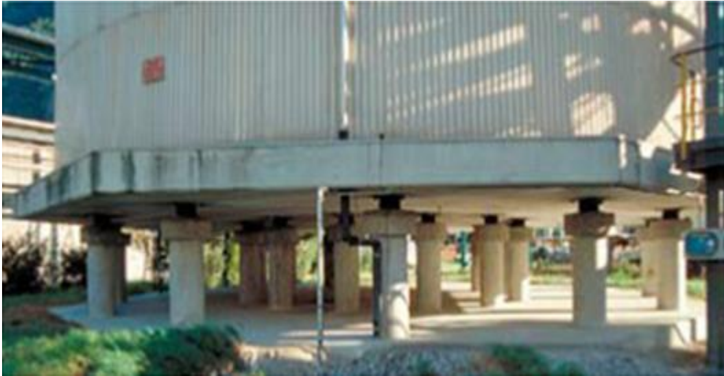
Figure 2.6 : Réservoir de gaz posé sur isolateur inséré sur les socles
