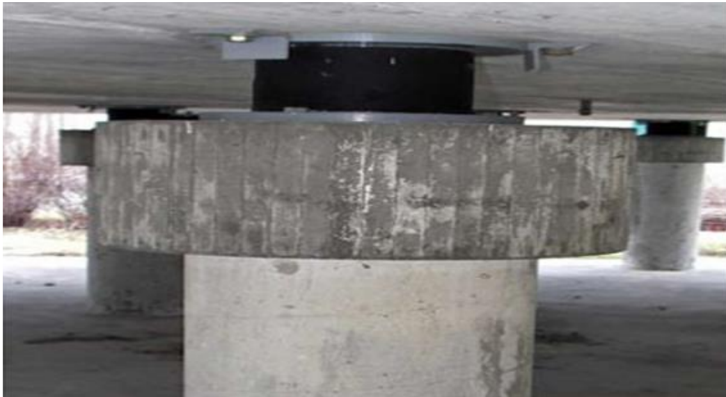
Figure 2.7 : L'isolateur du réservoir de gaz liquide vue de près
