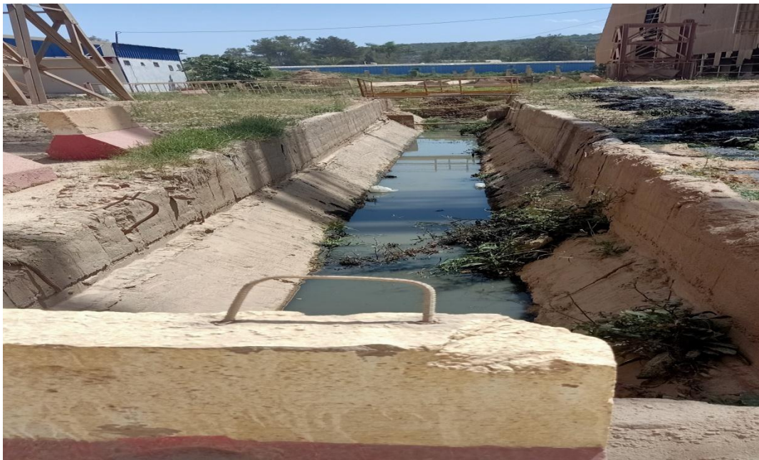
Photo IV.3: Canalisation à ciel ouvert (SEHIRI.A, DAHMAN.A)
