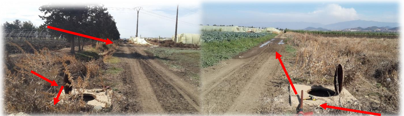
Photos II. 16 : Itinéraire du collecteur d'assainissement
