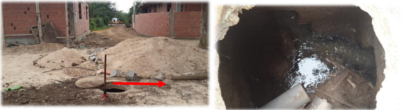
Photos II. 12 : Regards existants presque colmaté
