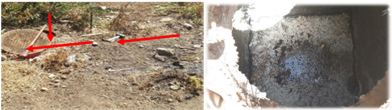
Photos II. 14 : Regard existant entièrement colmaté
