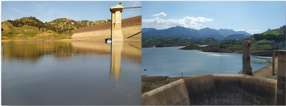
Figure 10: L'état du barrage et le niveau d'eau bas (Photos, Avril 2021).
