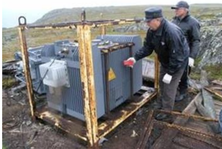
Figure I.9 RTG utilisé pour alimenter les phares et les balises de navigation [28].
