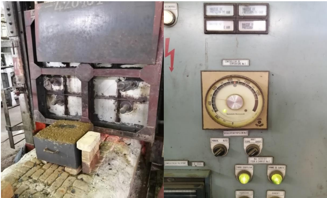
Figure III.5 : Four utilisé dans la cémentation.
