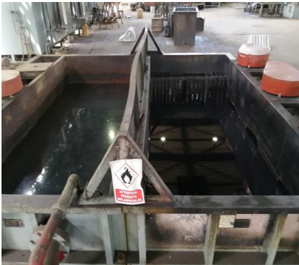
Figure III.10 : Le bain de refroidissement après la cémentation.
