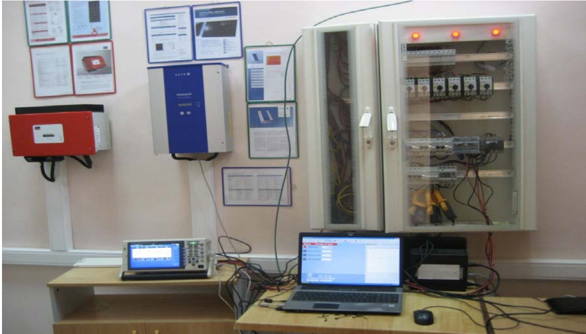
Figure 4.6 – plateforme de tests et de mesures au niveau de la salle de contrôle
