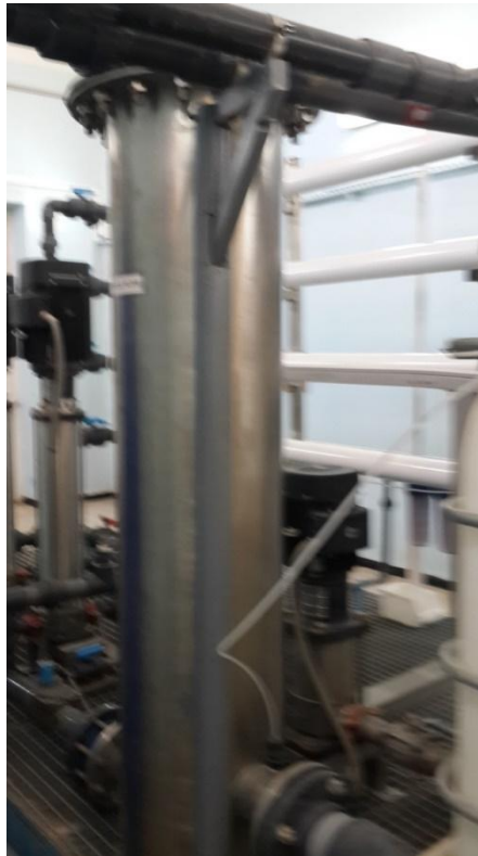
Figure II.2 : Filtres à cartouches au niveau de la station
